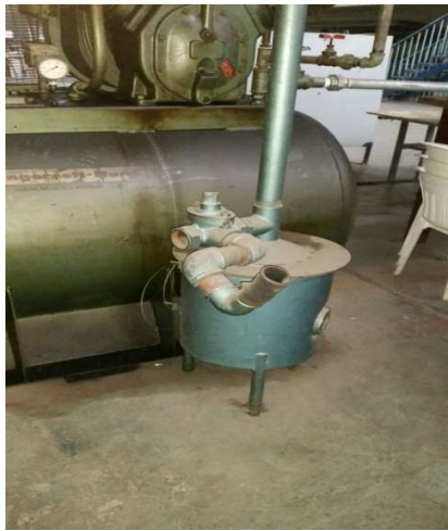
Figura 5.15: Fotografía de la toma de aire del compresor
