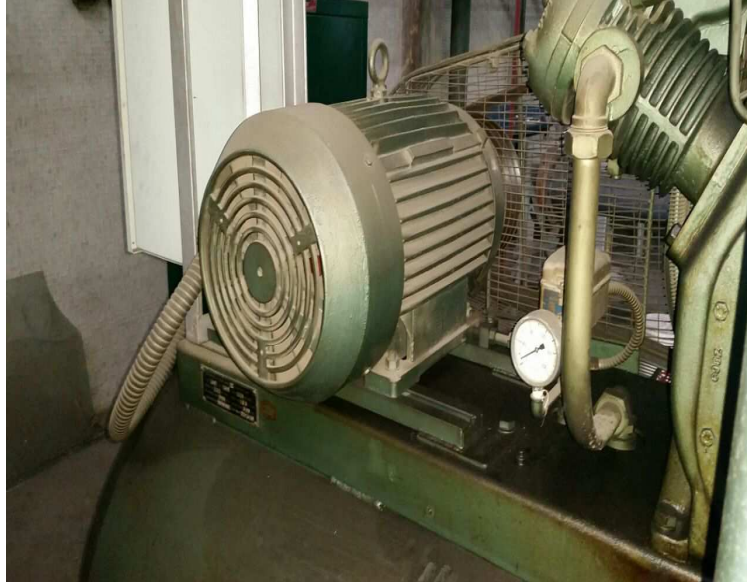
Motor eléctrico del compresor
