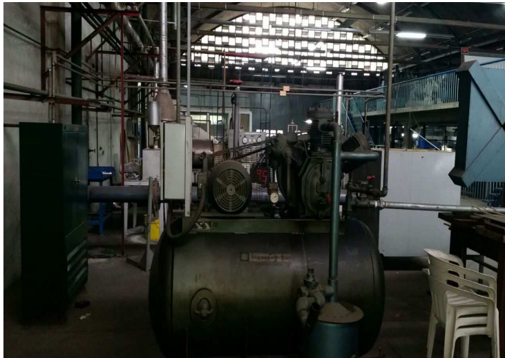
Vista posterior del compresor
