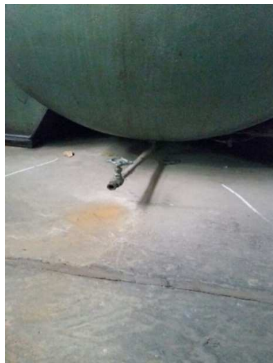
Figura 3.5: Tubería de descarga del tanque del compresor
