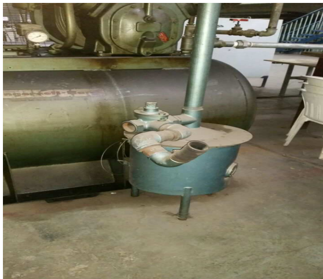
Toma de aire del compresor
