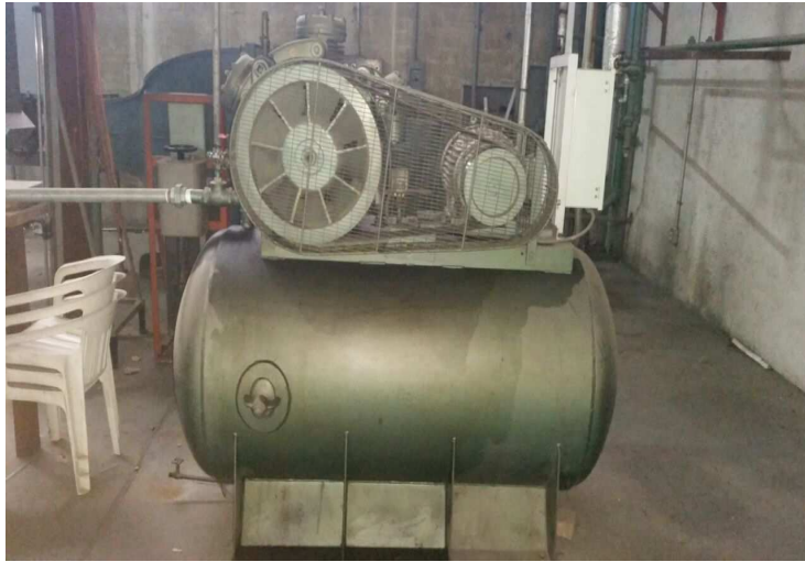
Vista frontal del compresor
