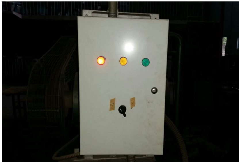
Cajeta del circuito de potencia del compresor (cerrada)
