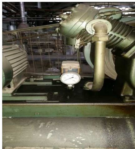
Figura 5.17: Manómetro del tanque del compresor.
