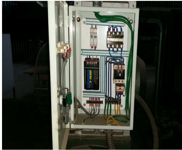
Figura 5.19. Cajeta de circuito de potencia abierta del compresor.
