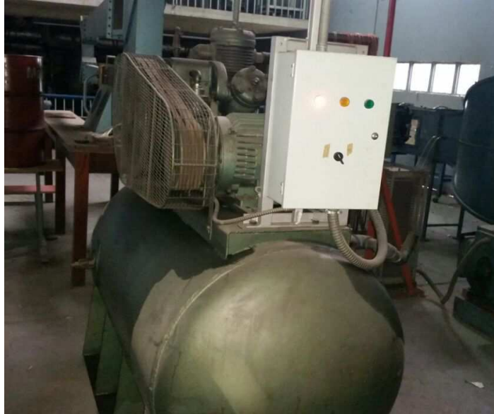
Parte lateral derecha del compresor
