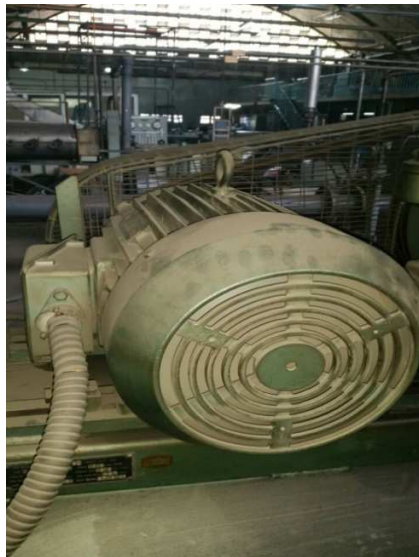
Motor eléctrico del compresor
