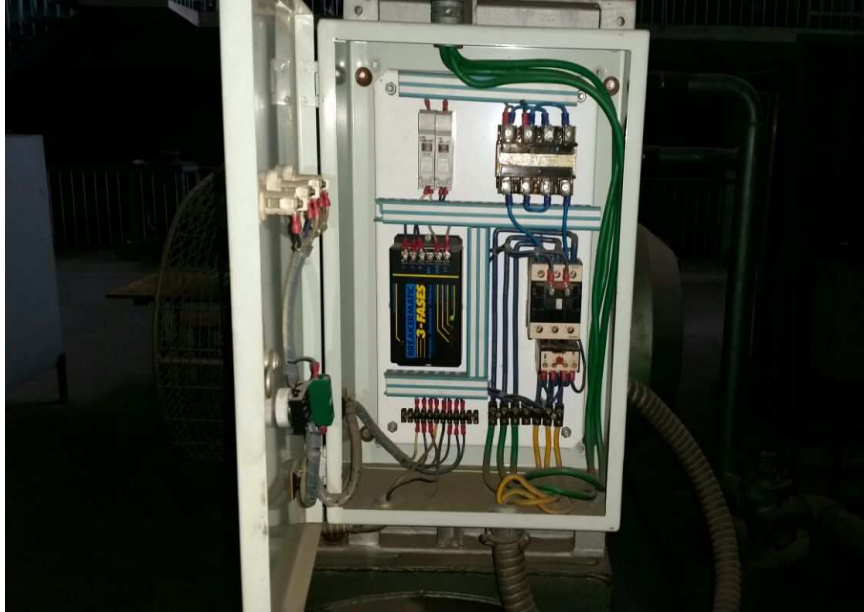
Cajeta del circuito de potencia del compresor (abierta)
