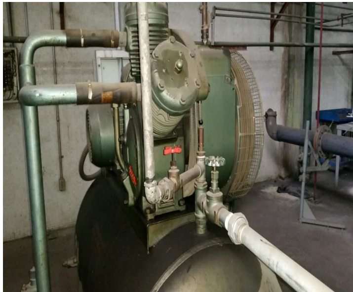
Tuberías de succión de aire y tuberías de servicio
