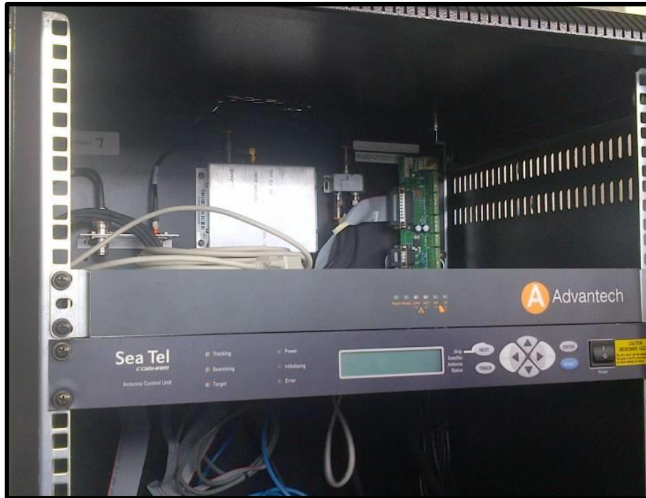
Equipos ubicados en el rack de comunicaciones.
