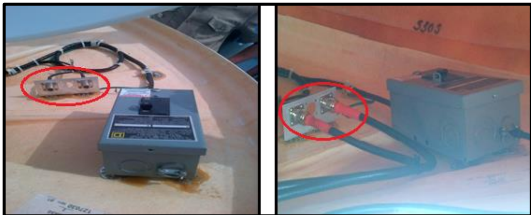
Figura 23. Placa terminal para Tx y Rx antes (izquierda) y después (derecha) de realizar las conexiones.
