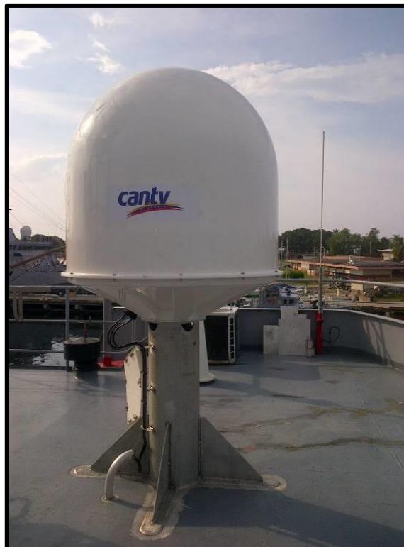
Antena instalada y operativa.
