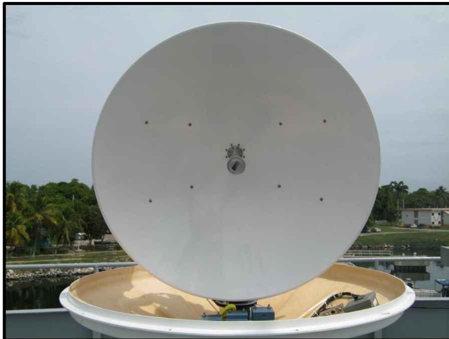
Vista frontal de la antena.
