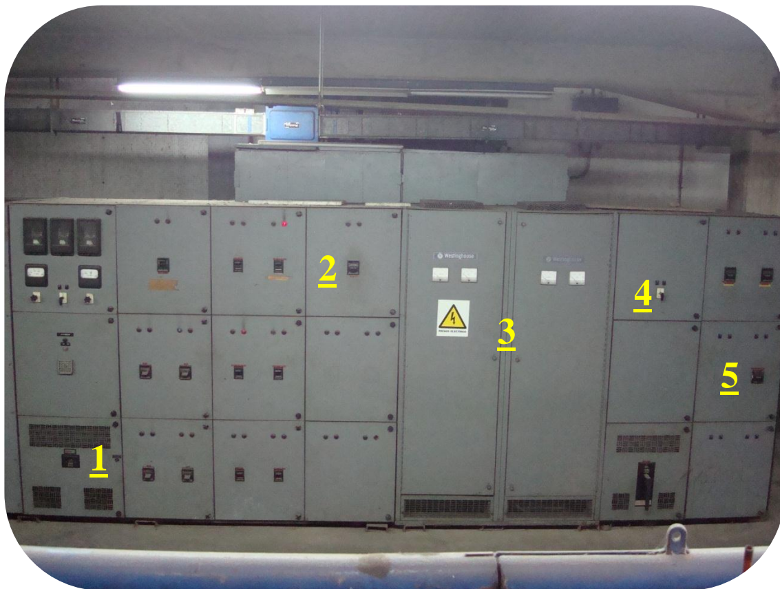
Foto. 15. Centro de control, distribución, protección y unidades rectificadoras.
