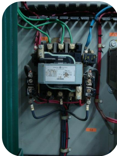
Foto. 29. Contactor asociado al motor de inducción.
