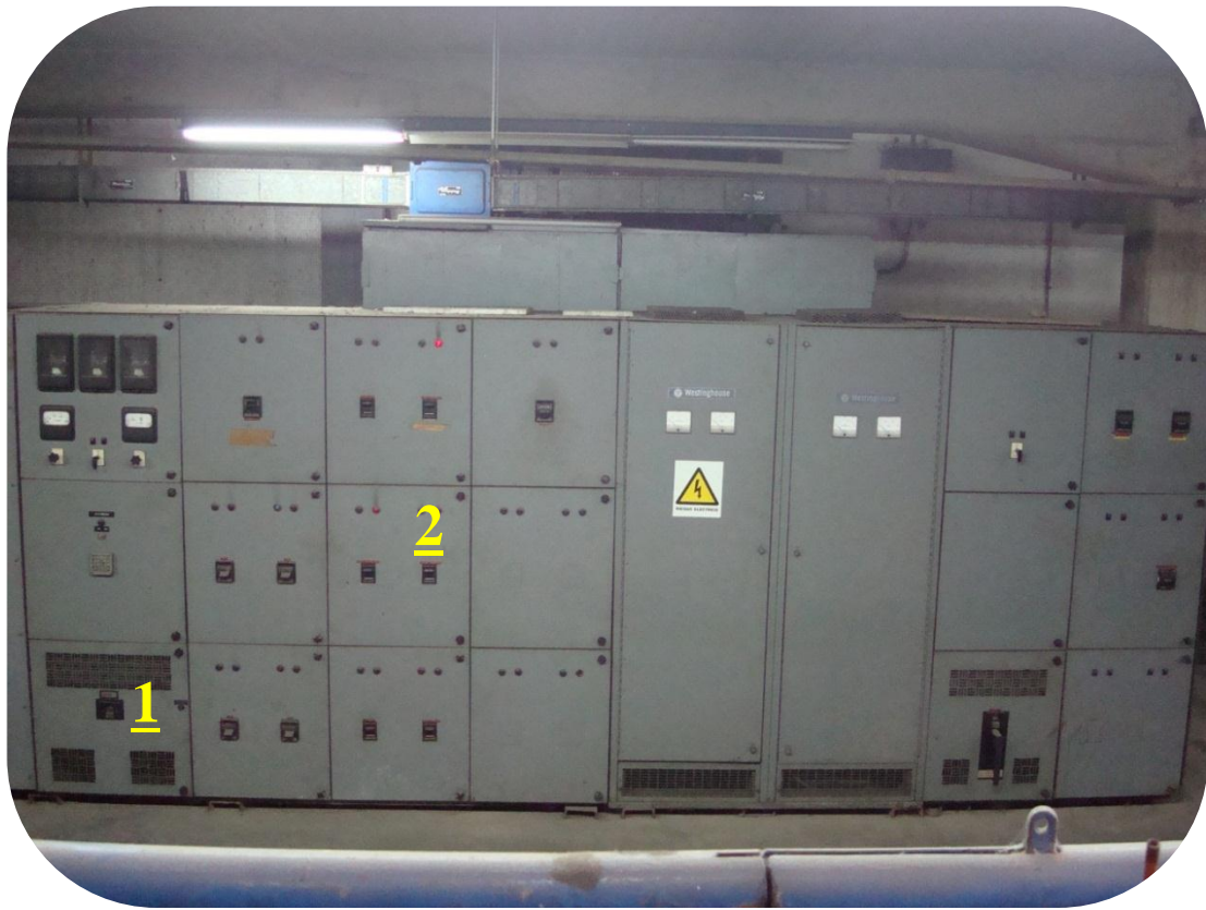
Foto. 21. Centro de control, distribución y protección B.C.
