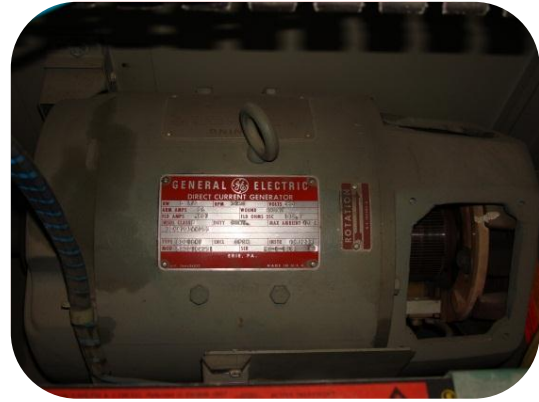
Foto. 32. Generador DC del sistema de fuerza.
