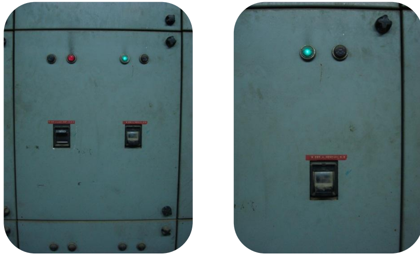
Foto. 23. Interruptor principal AC del circuito asociado a la mezzanina.
