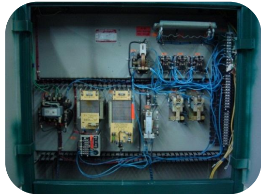
Foto. 27. Conexiones y equipos en la parte interna del gabinete.
