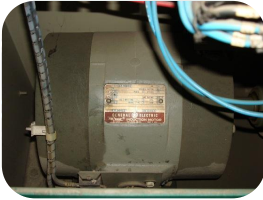
Foto. 31. Motor de inducción del sistema de fuerza.
