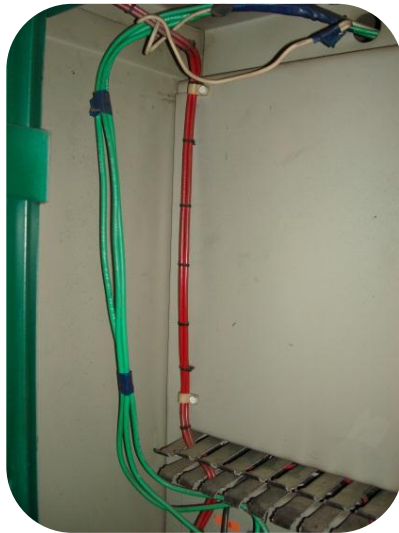
Foto. 28. Cables de alimentación al contactor del motor de inducción.
