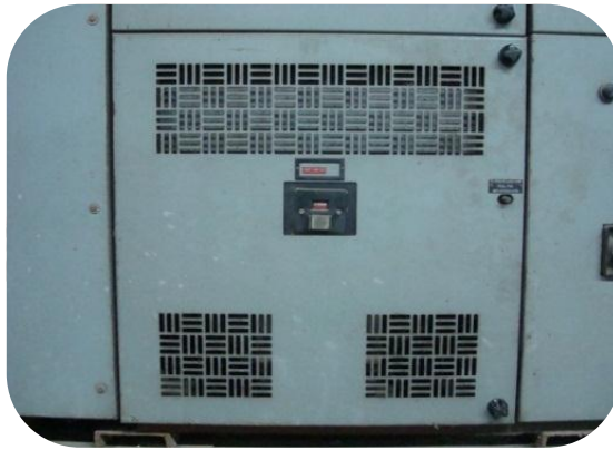
Foto. 16. Interruptor principal AC del centro de control, distribución y protección.
