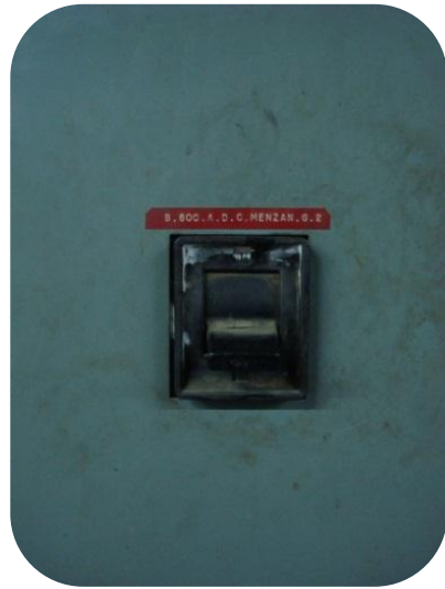
Foto. 20. Interruptor DC asociado al circuito eléctrico del banco T.F.
