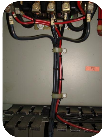
Foto. 30. Cables de alimentación del motor de inducción.
