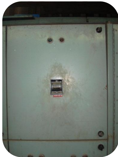
Foto. 17. Interruptor aguas arriba de las unidades rectificadoras.
