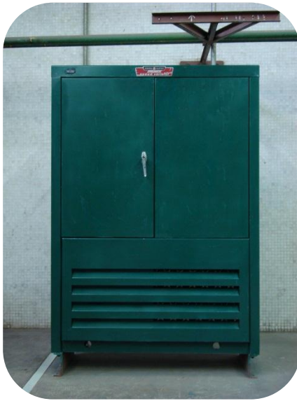
Foto. 25. Gabinete asociado a las conexiones eléctricas del sistema de fuerza, control y protección.
