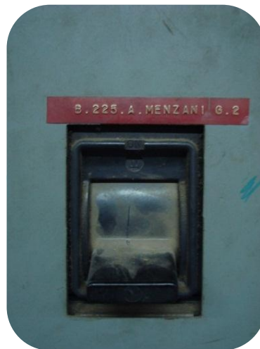
Foto. 24. Identificación del interruptor principal del circuito asociado a la mezzanina.
