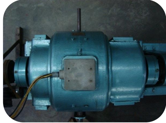
Foto. 7. Vista de planta del motor e identificación de la bornera.
