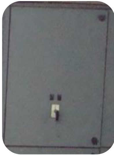
Foto. 19. Interruptor principal DC.
