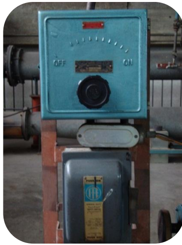
Foto. 2. Arrancador y fusilera del motor.
