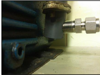
Figura N°40. Daño en la válvula de succión del fluido de P-102
