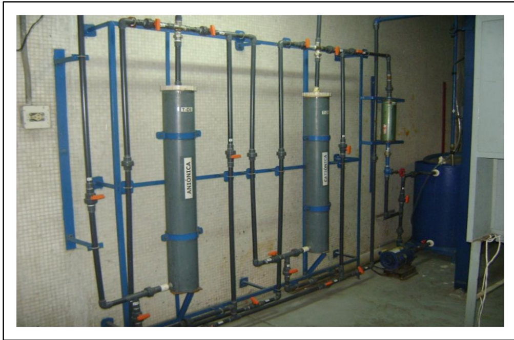
Figura 16. Planta de tratamiento de agua desmineralizada (Vista Oeste-Este) (Elaboración propia).
