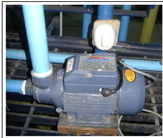
Figura 22. Bomba centrífuga Domosa y interruptor de encendido (Elaboración Propia).
