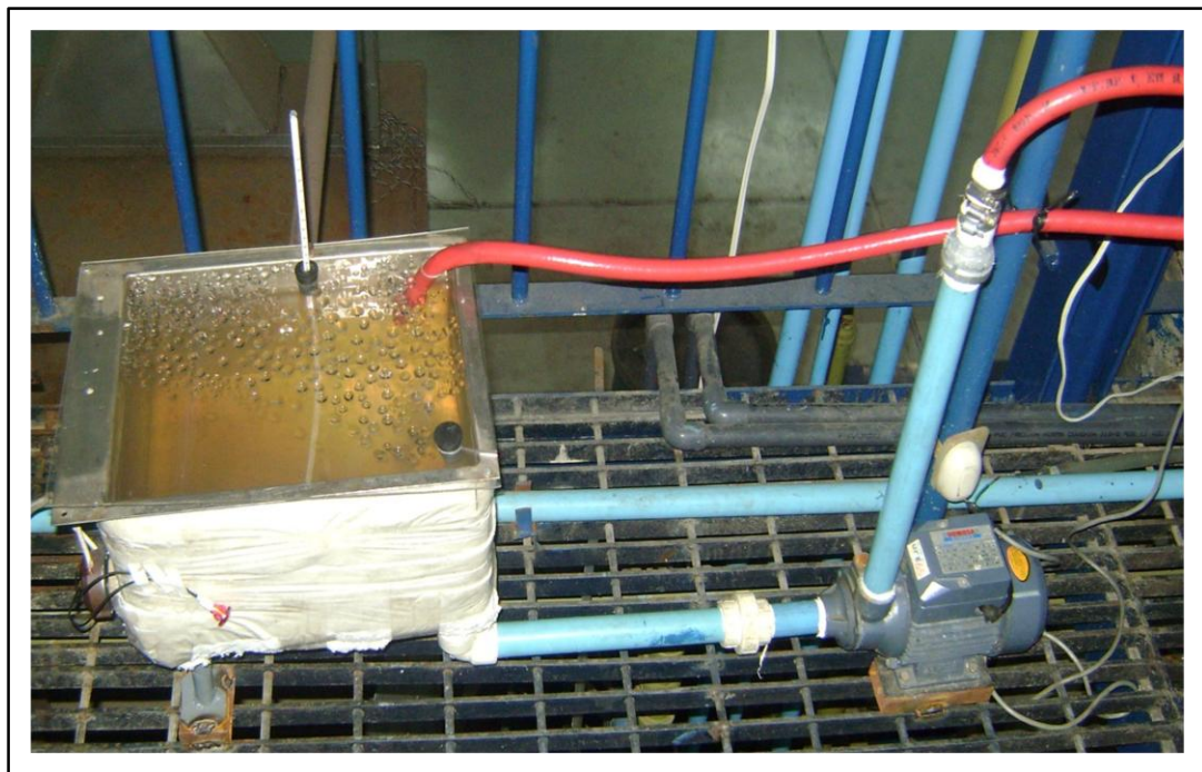
Figura 27. Tuberías y uniones de PVC, reductores y mangueras en el sistema (Elaboración Propia).
