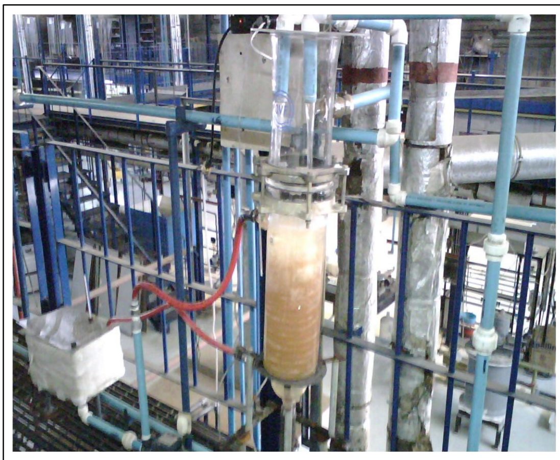
Figura 28. Sistema de calentamiento y prueba de inhibidores anti-incrustantes en tuberías de agua de producción (Elaboración propia).
