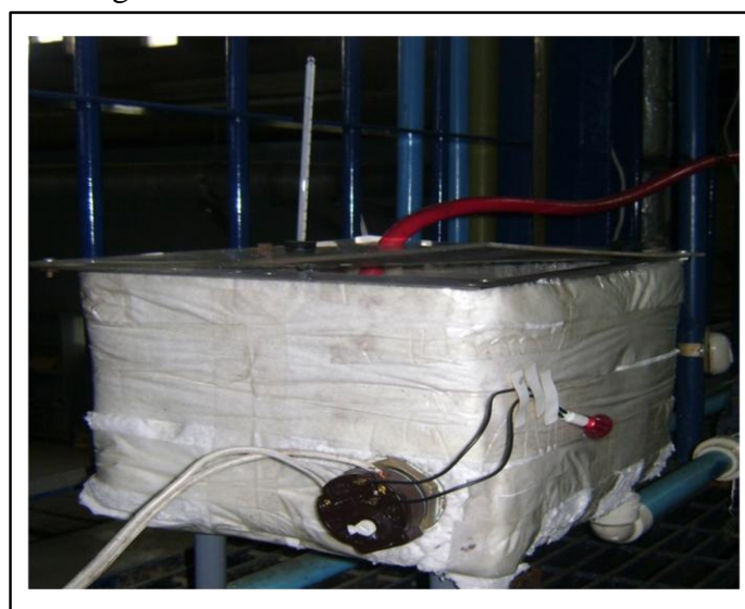
Figura 26. Termostato y bombillo, para regular la temperatura en el tanque (T-302) (Elaboración propia).
