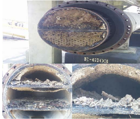
Figura 12. Intercambiadores de calor afectados por incrustaciones
