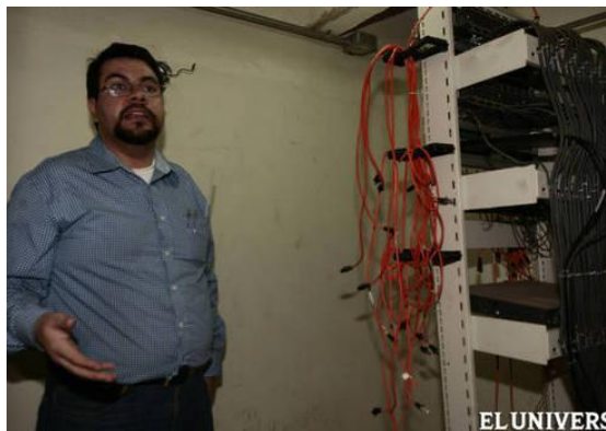
Graves daños se causaron al sistema de comunicaciones del edificio Los Chaguaramos ENIO PERDOMO
