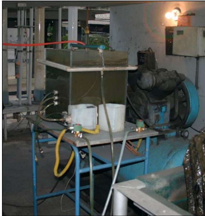
Figura 4: Válvulas y tuberías
