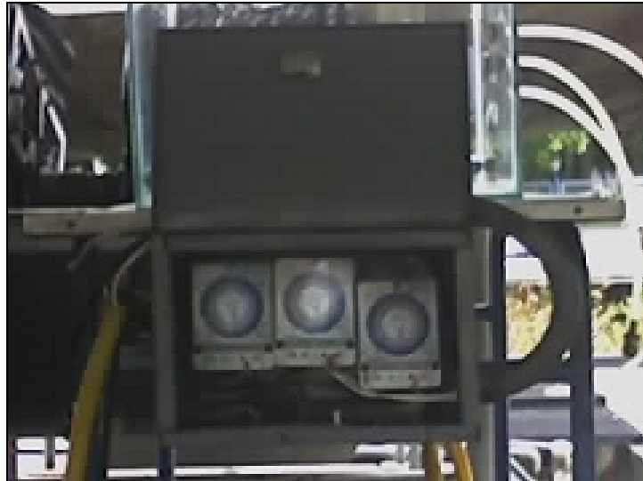
Figura 5: Tablero de control (Temporizadores).
