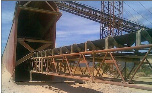
Foto 5.11. Banda transportadora tipo túnel
