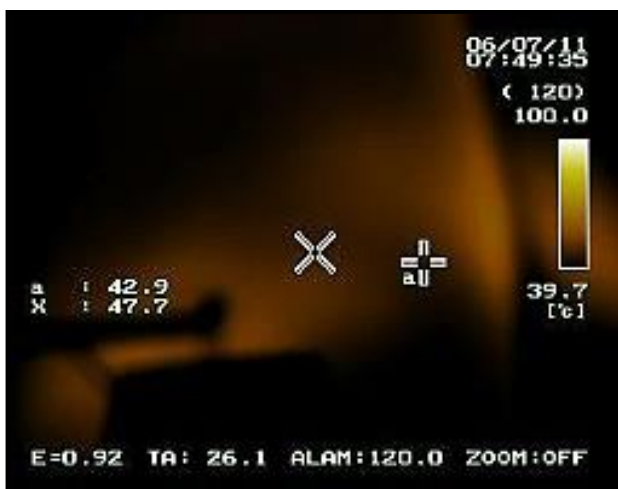
Figura 37. Imagen termográfica del silo de carbón
