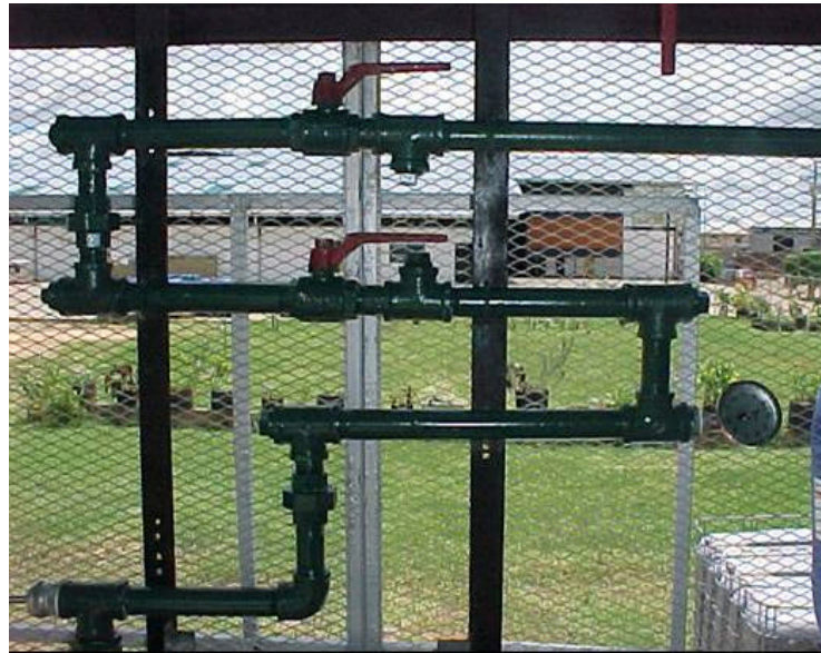
Figura N° 34. Soporte de pruebas de corrosión o cuponera
