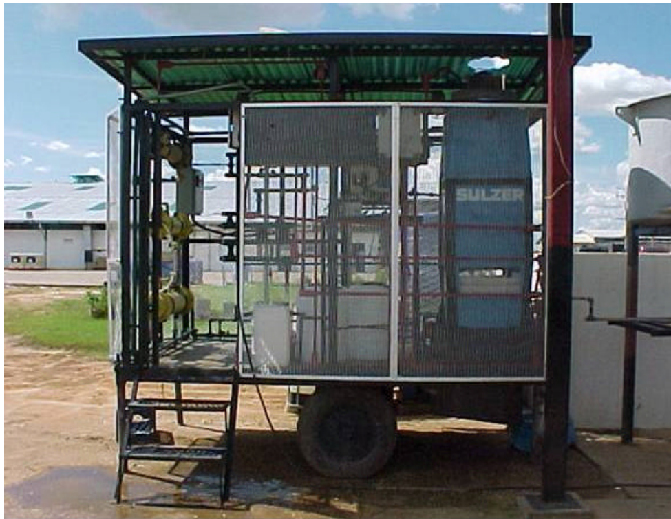
Figura N° 32. Vista frontal del Sistema de Enfriamiento Piloto LIPESA.
