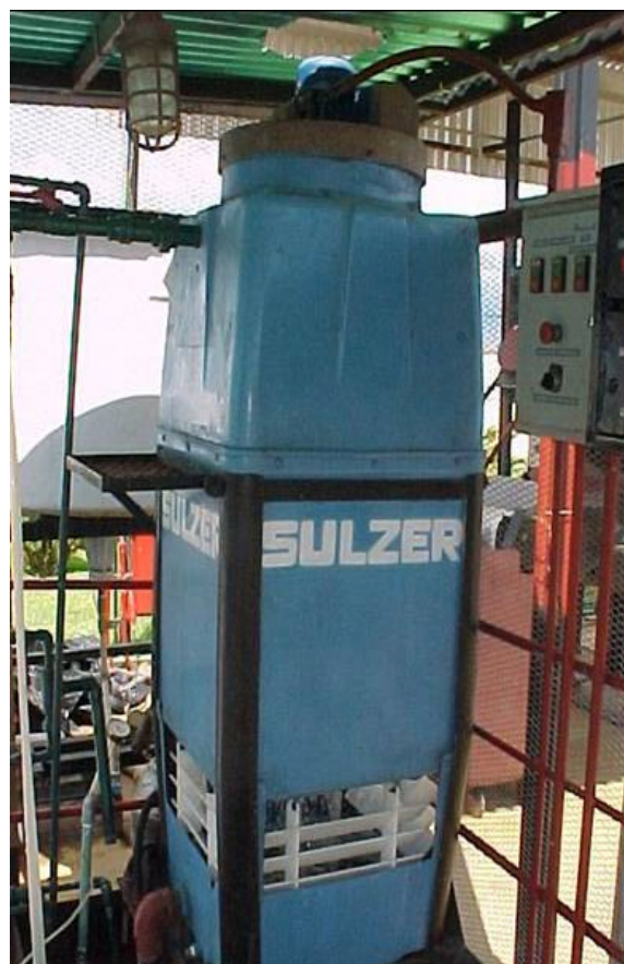
Figura N° 33. Torre de enfriamiento perteneciente al Sistema Piloto LIPESA.
