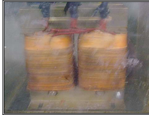
Figura N° 16. Transformador de corriente de 220 voltios
