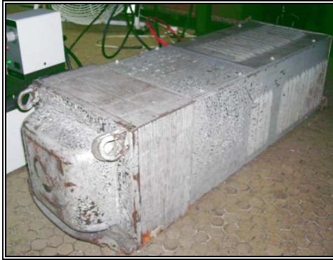
Figura N° 15. Rectificador de corriente de 110 voltios
