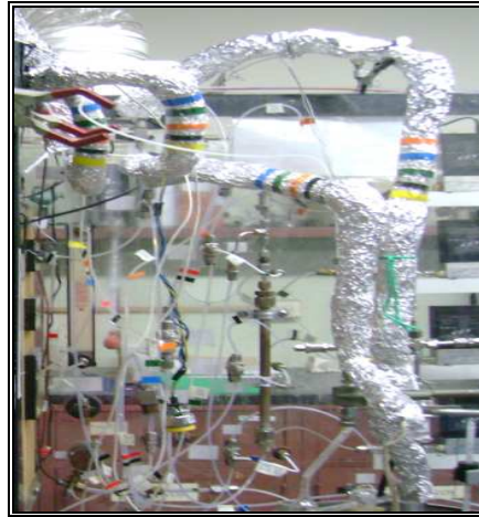
Figura N° 23. Sistema de tuberías aisladas.
