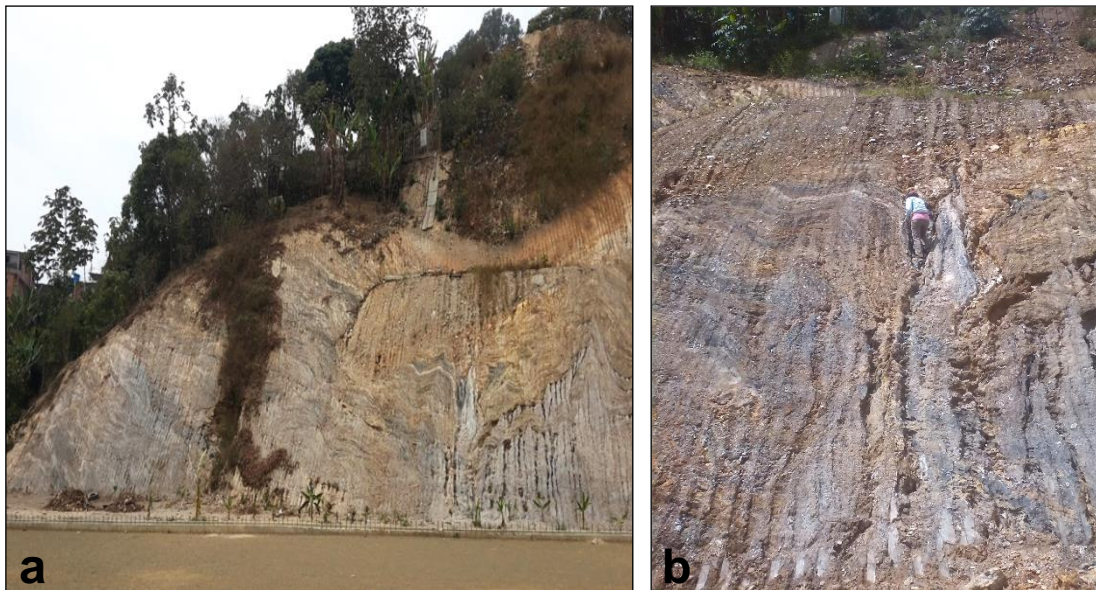
Figura 12. a) Filitas cuarzo – grafitosas cubiertas por vegetación y con cárcavas de hasta 2 metros de longitud. b) Vista local de Filitas cuarzo – grafitosas y cárcavas producto de la meteorización de aguas residuales.
