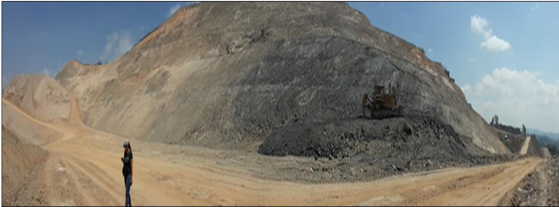
Figura 22. Panorámica realizada entre los puntos de levantamiento 47 y 48 donde se observa como realizan el corte del talud, además se observa el esquistos calcícticos – grafitosos hacia la base del afloramiento.
