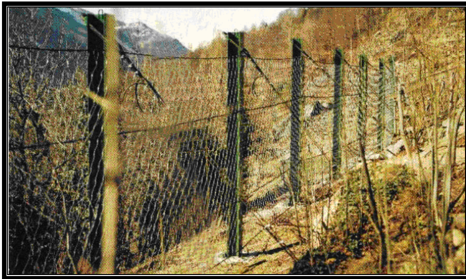
Figura 57 . Pantalla Dinámica para Protección Contra Caída de Bloques.
