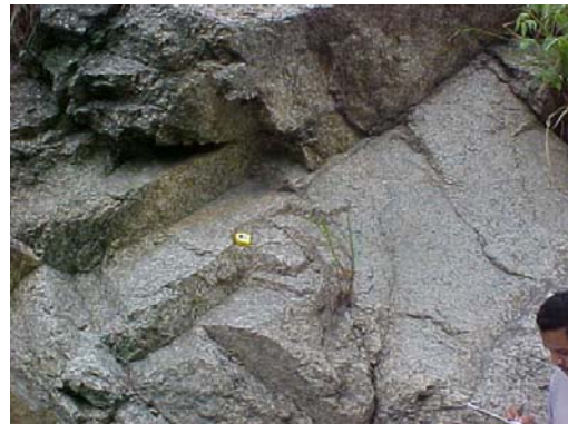
Foto 15. Vista de diaclasas del Talud # 20
