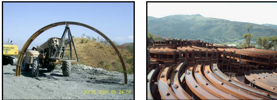
Figura 7.3. Costillas utilizadas en el Túnel trasvase Taguaguay-Valles de Tucutunemo.
