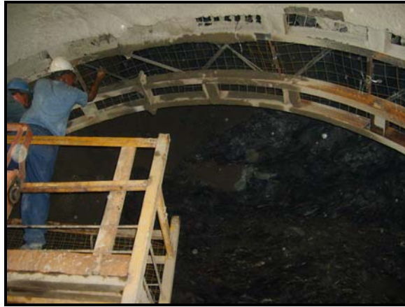
Figura 7.4. Malla electrosoldada 10X10 utilizada en el Túnel trasvase Taguiguay-Valles de Tucutunemo. Tomada por: Rosangela Martínez (2008)
