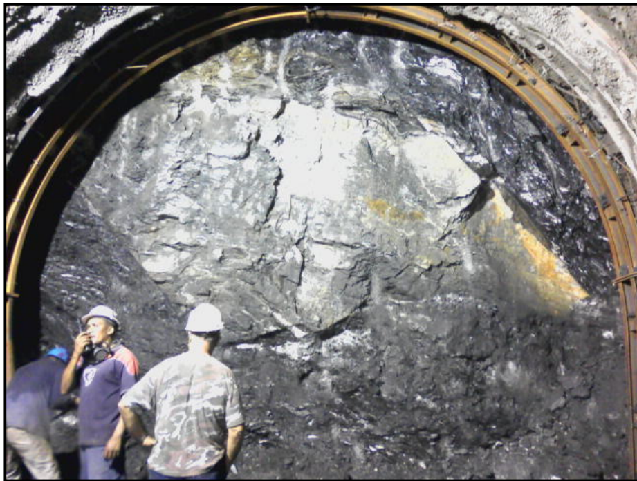
Figura 9.29. Disposición del bloque de diabasa en el frente de excavación. Progresiva 0+110.57. Tomada por: Rosangela Martínez (2008)
