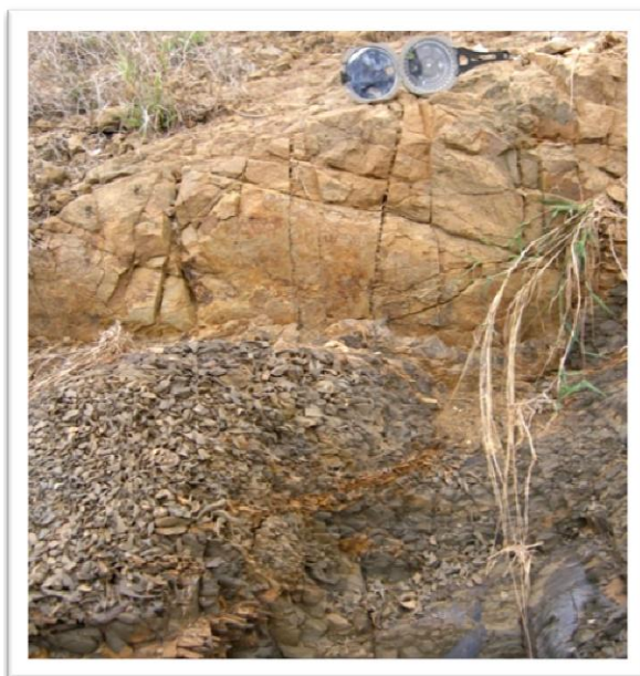
Figura C5. Afloramiento de la arenisca diaclasada y lutita fracturada.
