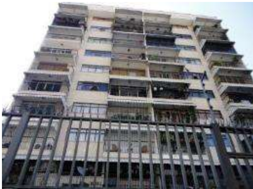
Imagen 49: Fachada principal. Pintura desmenuzada. Caso Estudio 1. Fuente FF
