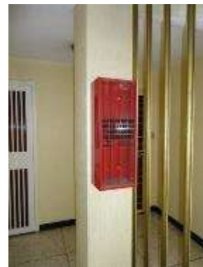
Imagen 7. Caja del extintor del piso vacía. Fuente FF
