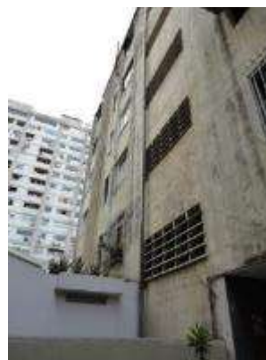
Imagen 69: Fachada sur. Cableado sin canalización. Caso estudio 2. Fuente FF
