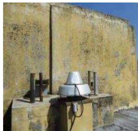
Imagen 62: Fachada norte. Pintura desconchada. Caso estudio 5. Fuente FF
