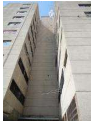
Imagen 50: Fachada sur. Pintura desmenuzada. Caso Estudio 1. Fuente FF
