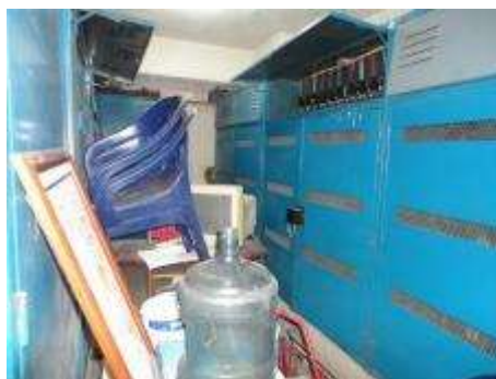
Imagen 83: Cuarto Eléctrico PB. Desechos en zonas de circulación. Caso estudio 5. Fuente FF
