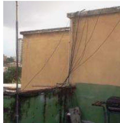
Imagen 80: Detalle Techo. Cableado sin canalización. Caso estudio 4. Fuente FF
