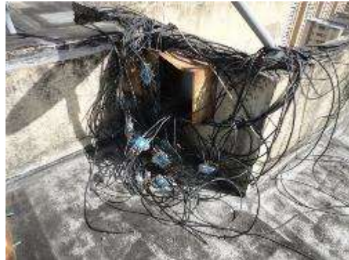
Imagen 39. Cableado de TV. Fuente FF
