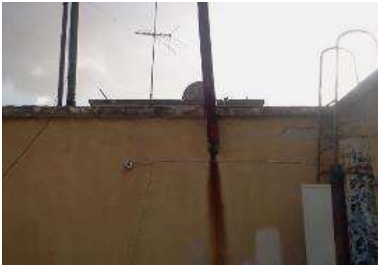
Imagen 47: Humedad losa techo. Caso estudio 4. Fuente FF.
