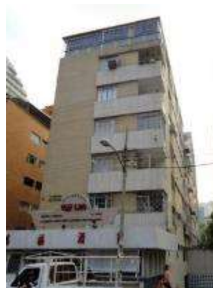
Imagen 52: Fachada principal. Pintura desmenuzada. Caso Estudio 2. Fuente FF
