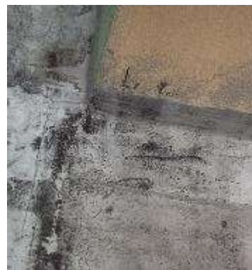
Imagen 74: Detalle techo. Estado impermeabilización. Caso estudio 4. Fuente FF
