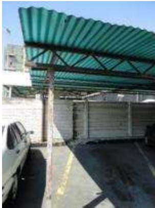
Imagen 85: Detalle techo estacionamiento PB. Anclaje de techo causa humedad en sótano. Caso Estudio 1. Fuente FF
