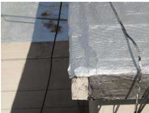
Imagen 73: Detalle techo. Estado impermeabilización. Caso estudio 1. Fuente FF
