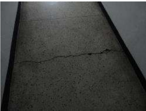
Imagen 42: Fisura junta de dilatación. Caso estudio 2. Fuente FF.
