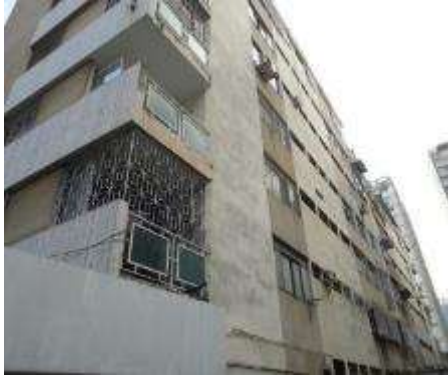
Imagen 53: Fachada norte. Pintura desconchada. Signos de humedad. Caso Estudio 2. Fuente FF
