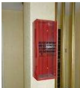
Imagen 98: Cajón metálico de extintores vacío. Caso estudio 5. Fuente FF.
