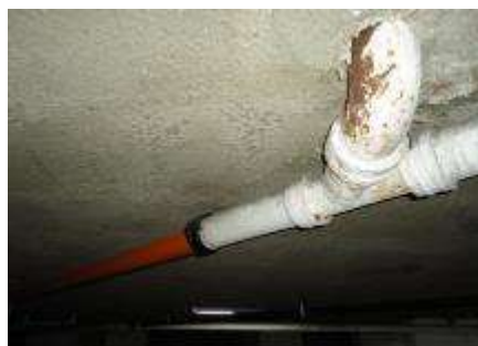
Imagen 88: Estacionamiento sótano. Empate tubería hierro con PVC. Caso estudio 1. Fuente FF
