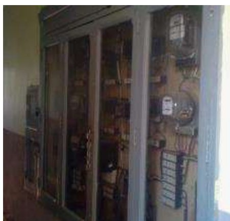
Fotografía 29. Tablero principal de la edificación de madera. Fuente FF
