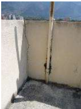
Imagen 75: Detalle antepecho. Grieta. Caso estudio 5. Fuente FF
