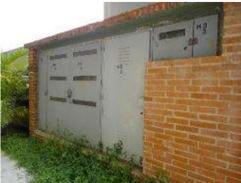
Imagen 111. Caja de medidores. Torre H. Fuente FF
