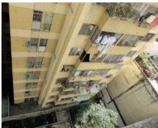
Imagen 61: Sección fachada sur. Pintura desconchada. Caso estudio 5. Fuente FF
