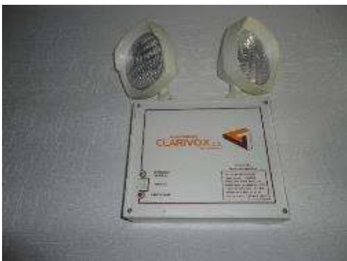
Imagen 107. Equipo iluminación emergencia. Torre H. Fuente FF
