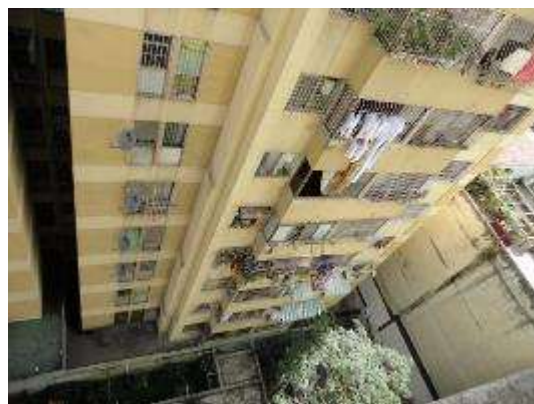
Imagen 72: Detalle fachada sur. Cableado sin canalización. Caso estudio 5. Fuente FF
