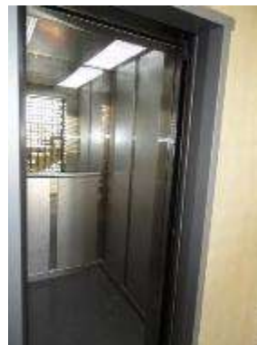
Imagen 5. Vista ascensores actualizados 2. Fuente FF
