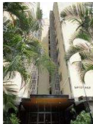
Imagen 56: Fachada principal. Pintura desconchada. Caso Estudio 3. Fuente FF
