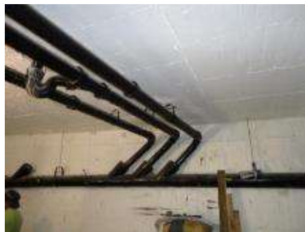
Imagen 21. Cambio de dirección en las tuberías de aguas negras
