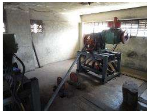
Imagen 35. Motor del elevador dañado asegurado con tubo. Fuente FF
