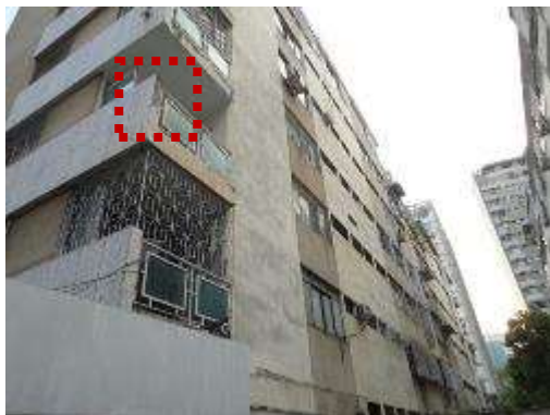
Imagen 67: Fachada Sur. Desprendimiento de piedra. Caso estudio 2. Fuente FF
