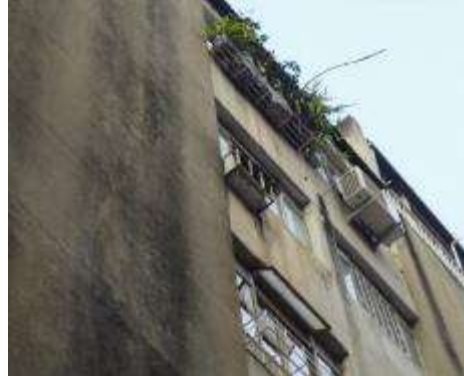
Imagen 54: Detalle fachada sur. Desgaste de acabados. Humedad. Caso Estudio 2. Fuente FF
