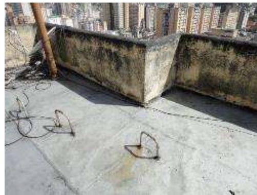
Imagen 76: Detalle antepecho. Cableado sin canalización y humedad. Caso estudio 5. Fuente FF
