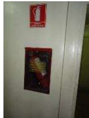
Imagen 41. Extintor en su cajón y señalización contra incendios. Fuente FF
