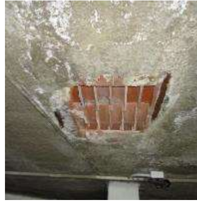
Imagen 86: Detalle techo estacionamiento. Signos de humedad en losa. Caso Estudio 1. Fuente FF
