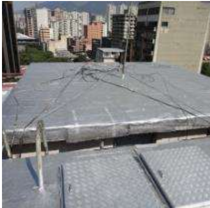
Imagen 79: Detalle Techo. Cableado sin canalización. Caso estudio 1. Fuente FF
