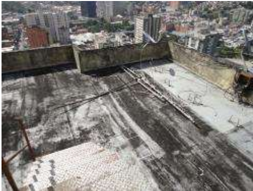
Imagen 38. Nivel de techo. Estado de la impermeabilización. Fuente FF
