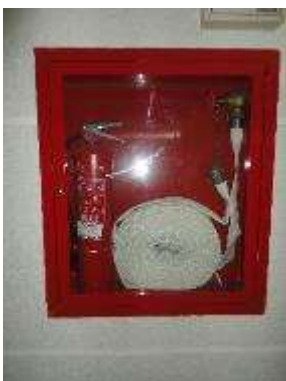
Imagen 109. Planta baja, caja equipos contraincendio. Torre H. Fuente FF
