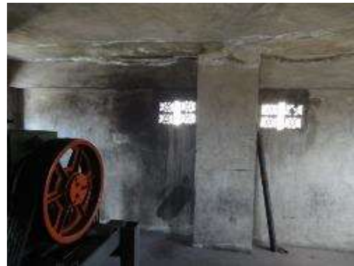
Imagen 48: Humedad losa techo. Caso estudio 5. Fuente FF.
