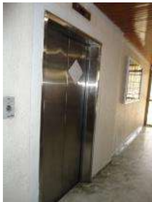
Imagen 91: Detalle planta baja. Ascensor averiado. Caso estudio 4. Fuente FF
