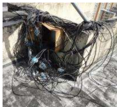
Imagen 81: Detalle Techo. Cableado sin canalización. Caso estudio 5. Fuente FF
