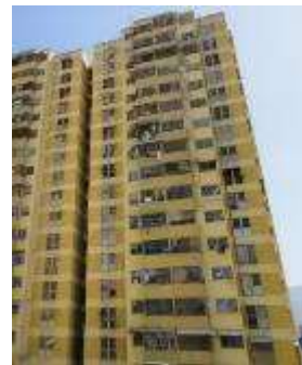
Imagen 60: Fachada sur. Pintura desconchada. Caso estudio 5. Fuente FF
