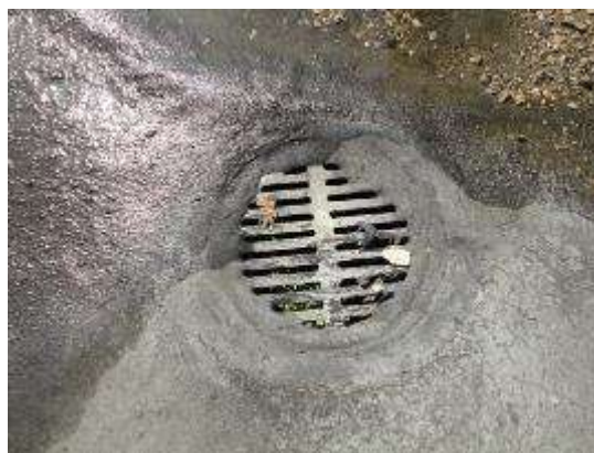
Imagen 78: Detalle techo. Vegetación creciendo en drenaje aguas de lluvia. C5. Fuente. FF
