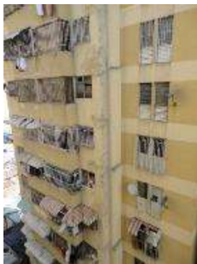
Imagen 65: Fachada Sur. Signos de humedad en fachada. Caso estudio 5. Fuente FF
