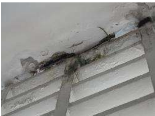
Imagen 45: Humedad losa techo. Caso estudio 2. Fuente FF.
