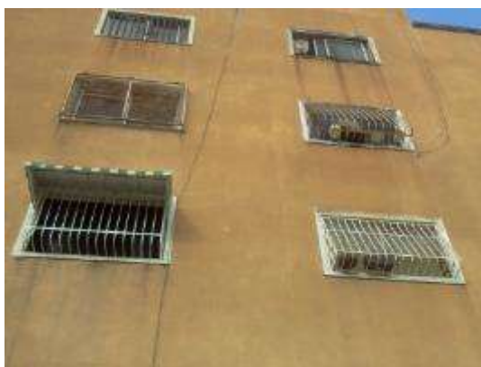
Imagen 70: Fachada sur. Cableado sin canalización. Caso estudio 4. Fuente FF
