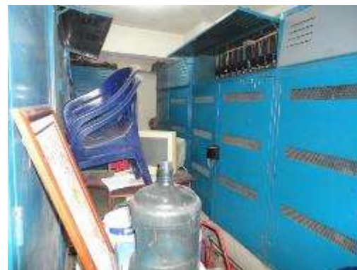
Imagen 37. Cuarto de tableros principal utilizado de depósito. Fuente FF
