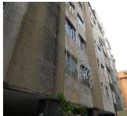
Imagen 66: Fachada Sur. Signos de humedad en fachada. Caso estudio 2. Fuente FF
