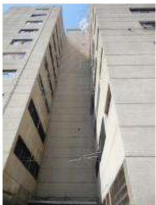
Imagen 68: Fachada sur. Cableado sin canalización. Caso estudio 1. Fuente FF
