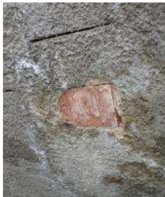
Imagen 87: Detalle techo estacionamiento. Signos de humedad en losa. Caso Estudio 1. Fuente FF
