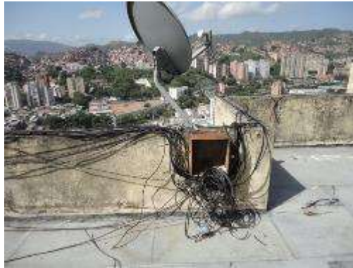
Imagen 97: Cableado TV por cable colapsado. Caso estudio 5. Fuente FF
