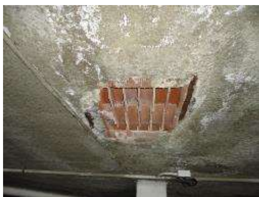
Imagen 10. Daño en bloque de arcilla y cabilla oxidada en la losa nervada de PB. Fuente FF
