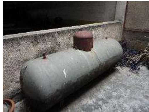
Imagen 17. Tanque de suministro de gas. Fuente FF
