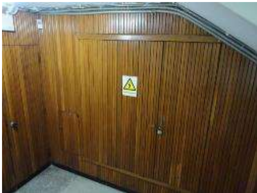
Imagen 16. Tablero principal torre este. Fuente FF
