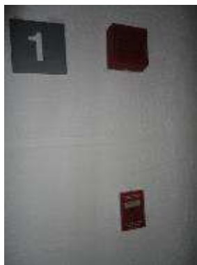
Imagen 108. Botón de emergencia y alarma. Torre H. Fuente FF
