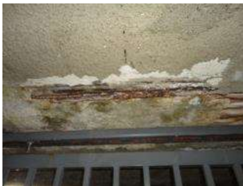
Imagen 44: Humedad losa estacionamiento. Caso estudio 1. Fuente FF.
