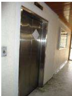
Imagen 36. Ascensor con notificación de avería. Fuente FF
