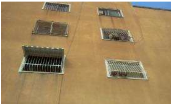
Imagen 59: Sección fachada sur. Pintura sin mantenimiento. Caso estudio 4. Fuente FF
