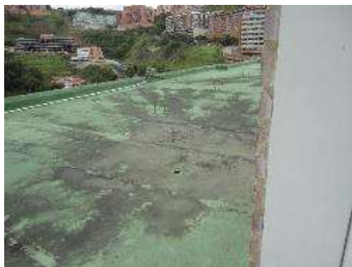
Imagen 102. Planta techo, estado actual impermeabilización 2. Torre H. Fuente FF
