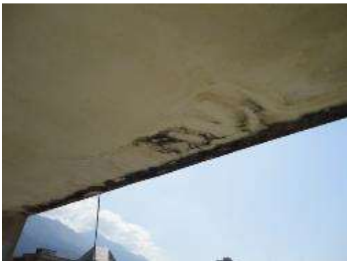
Imagen 43: Humedad losa tanque elevado. Caso estudio 1. Fuente FF.
