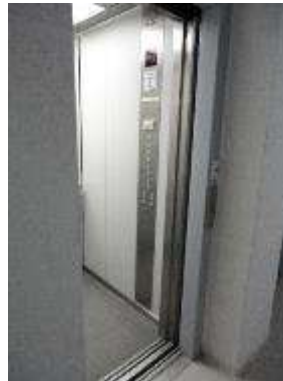
Imagen 104. Elevador en funcionamiento. Torre H. Fte. FF
