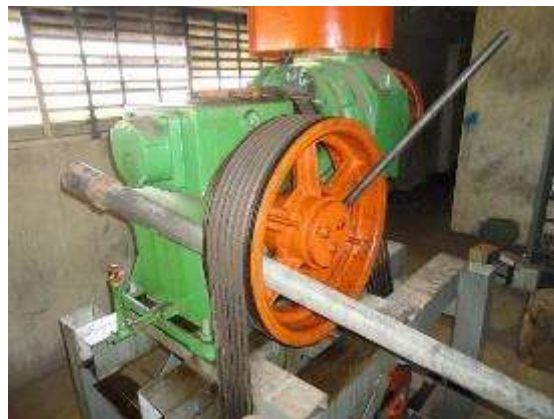
Imagen 92: Detalle cuarto de máquinas. Motor del ascensor averiado trabado. Caso estudio 4. Fuente FF
