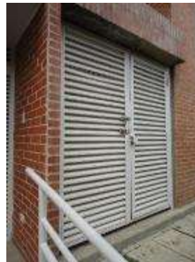
Imagen 112. Acceso cuarto eléctrico en PB. Torre H. Fuente FF
