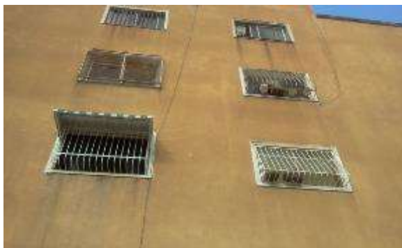
Fotografía 27. Fachadas laterales el cableado sin canalización. Fuente FF
