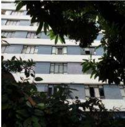
Imagen 57: Detalle fachada Norte. Daño en mosaico. Humedad. Caso Estudio 3. Fuente FF
