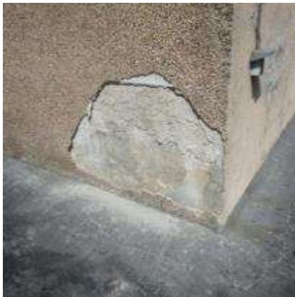
Imagen 51: Detalle fachada este. Piedra proyectada desmenuzada. Caso Estudio 1. Fuente FF
