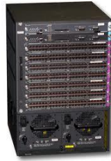
Figura N° D. 10. Switch Cisco Catalyst 6509
