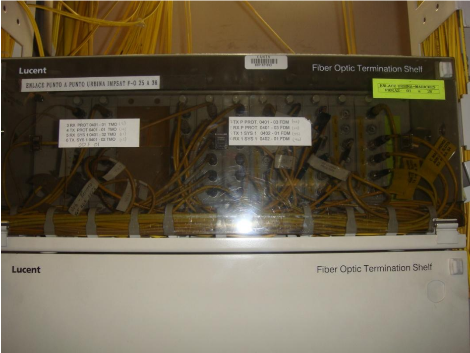
[Anexo] 14 ODF en la Central de la Urbina
