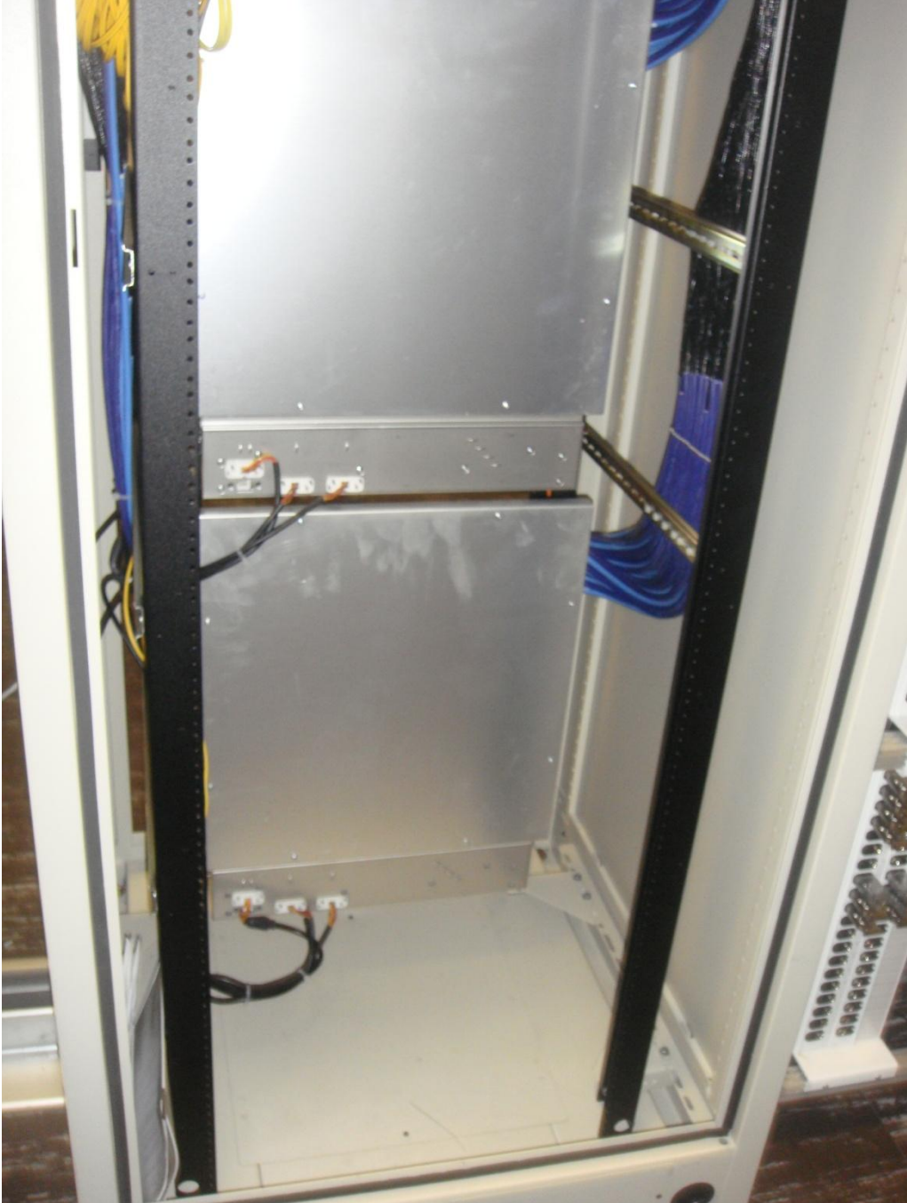
[Anexo] 15 Bastidor 19" para adaptación de SLM-2000
