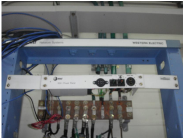
[Anexo] 2 Unidad de Distribución de Alimentación y fusibles
