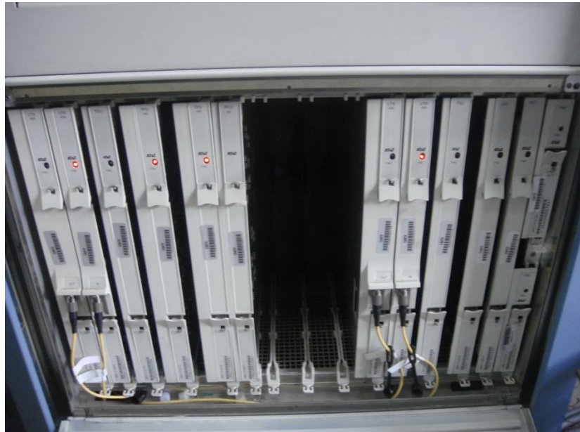
[Anexo] 4 Unidades TPU y TGU alarmadas
