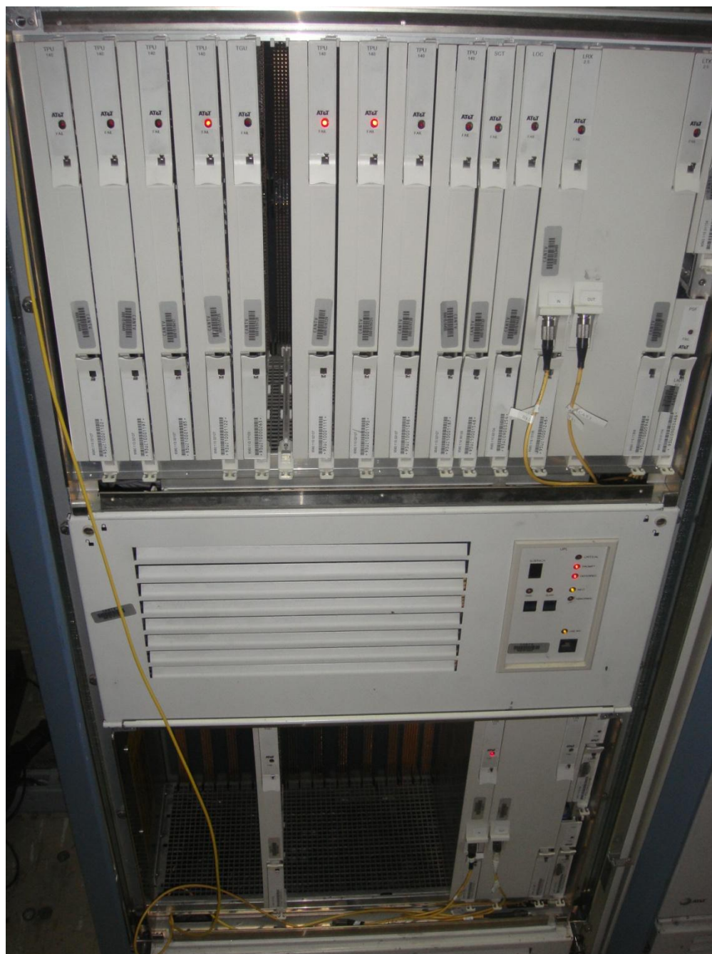
[Anexo] 21 SLM-2000 con tarjetas TPU alarmadas conexión 1 + 1
