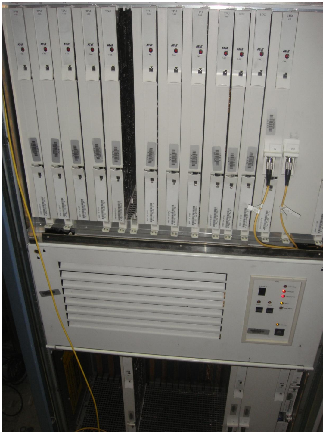
[Anexo] 22 SLM-2000 sin alarmas en tarjetas
