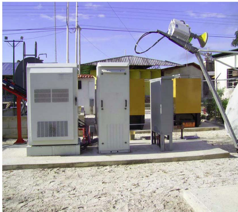
Foto 16: Maroa Amazonas, Estación Radio Base Actual CDMA [35]
