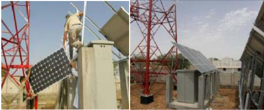
Foto 4. Ejemplo de Contenedores de Banco de Baterías [22]
