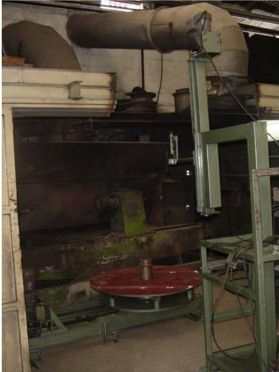
Mecanismo de rotación de la pieza y mecanismo de desplazamiento de la pistola
