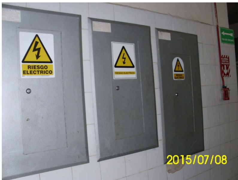
Anexo 12: Tablero eléctrico.
