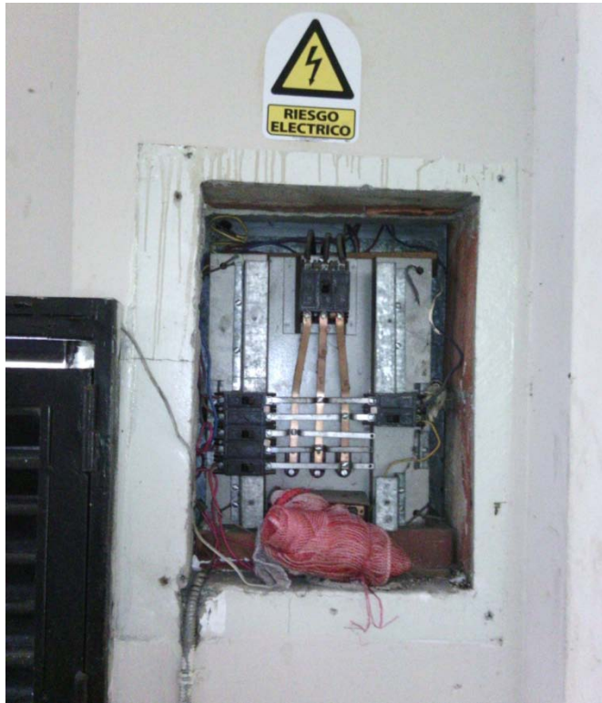
Anexo 13: Tablero eléctrico en mal estado.
