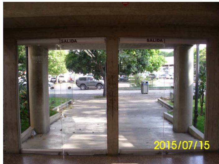
Anexo 5: Puertas de vidrio sin sistema de retorno automático ni apertura manual.
