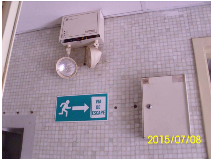
Anexo 6: Señalización de vía de escape en oficina.
