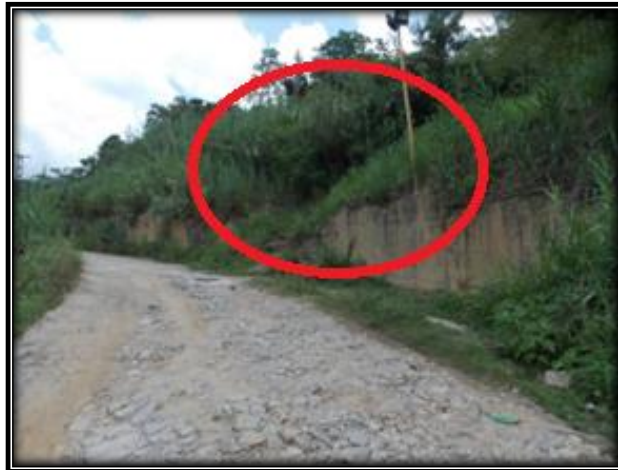
Figura.4.14. Deslizamiento antiguo que se denota dentro de la elipse roja. En la Calle del sector Las Terrazas
