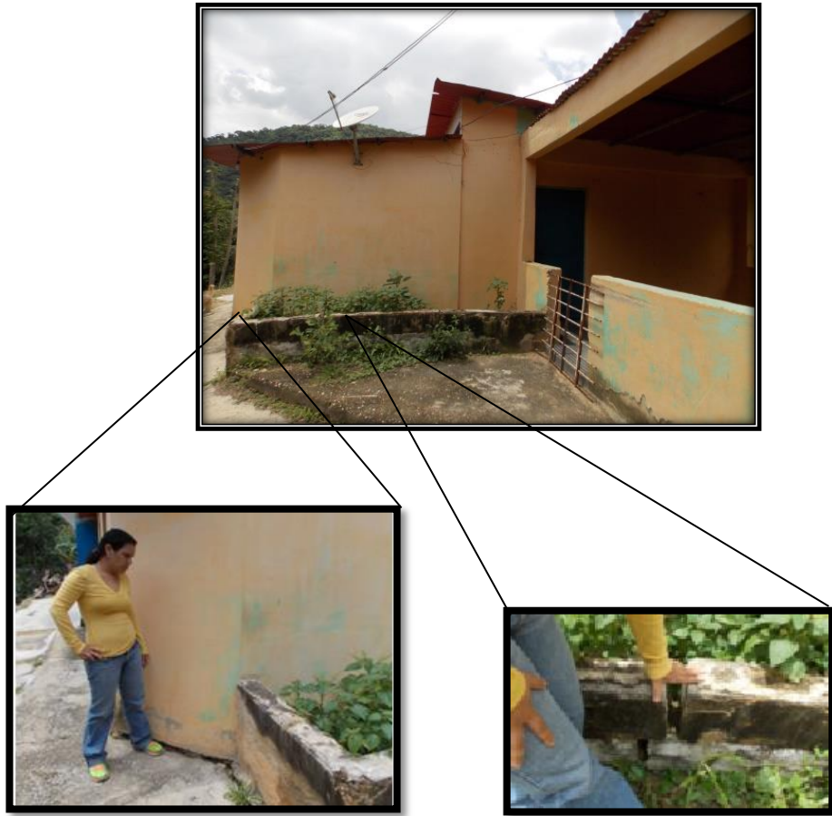
Figura.4.17. Vivienda con grietas en sector Las Terrazas de 3cm.
