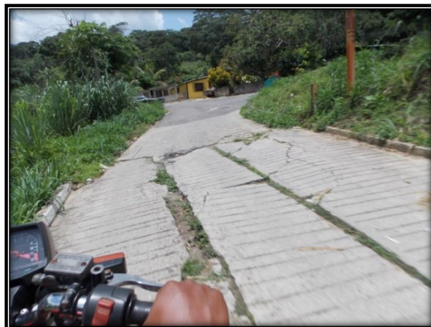
Figura.4.16. Grietas en la calle principal del sector Las Terrazas
