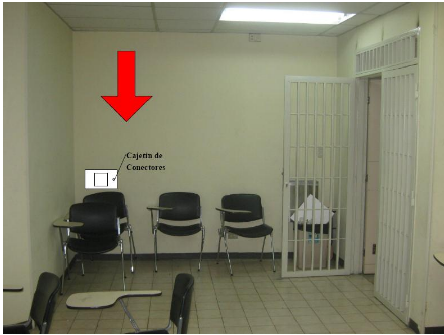
Figura 24. Ubicación Rack Móvil de Equipos.
