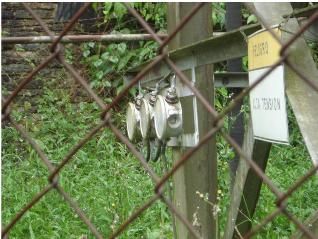
Contador de descargas atmosféricas ubicado en el pórtico de la S/E San Antonio, el cual no funciona.
