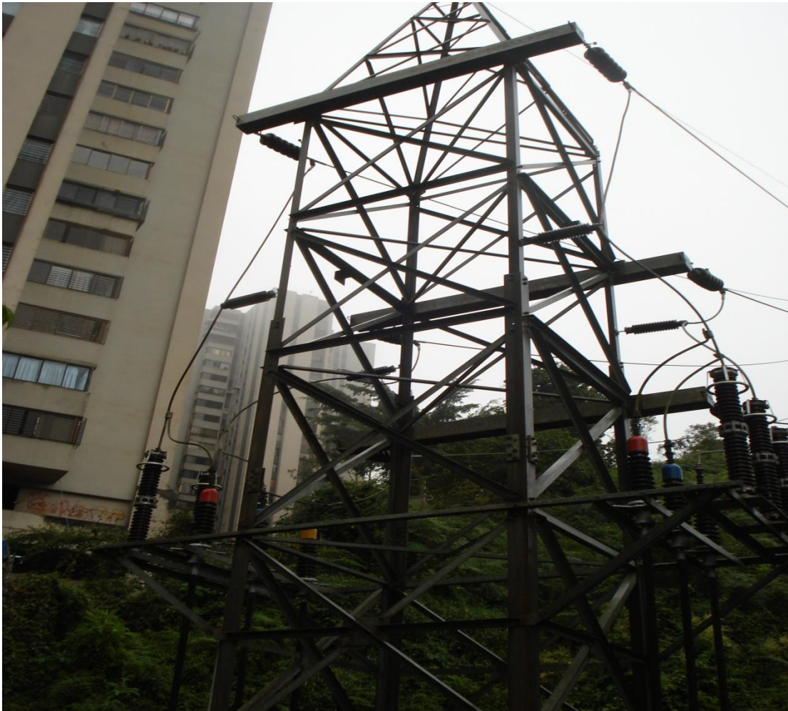
Pórtico S/E San Antonio.
