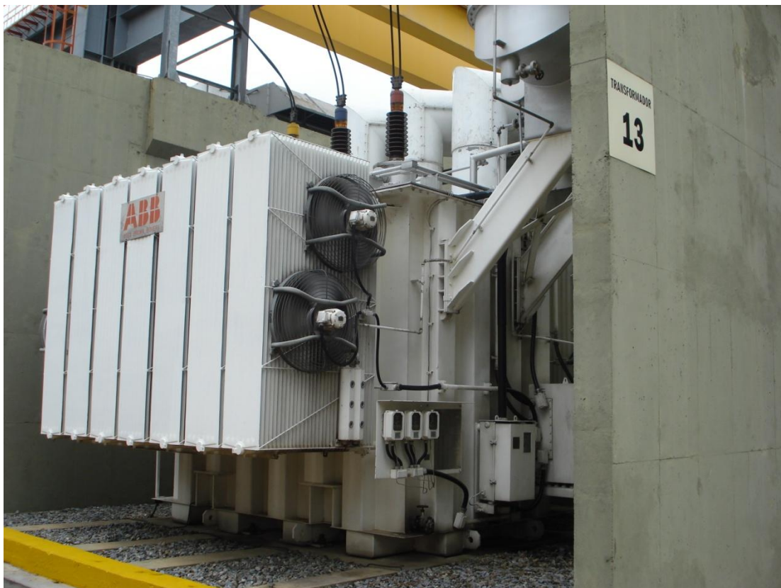
Vista del Transformador 13 de la máquina 13 en la planta OAM.
