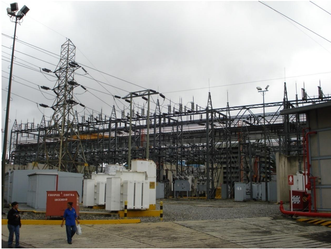
Vista frontal de la S/E OAM.
