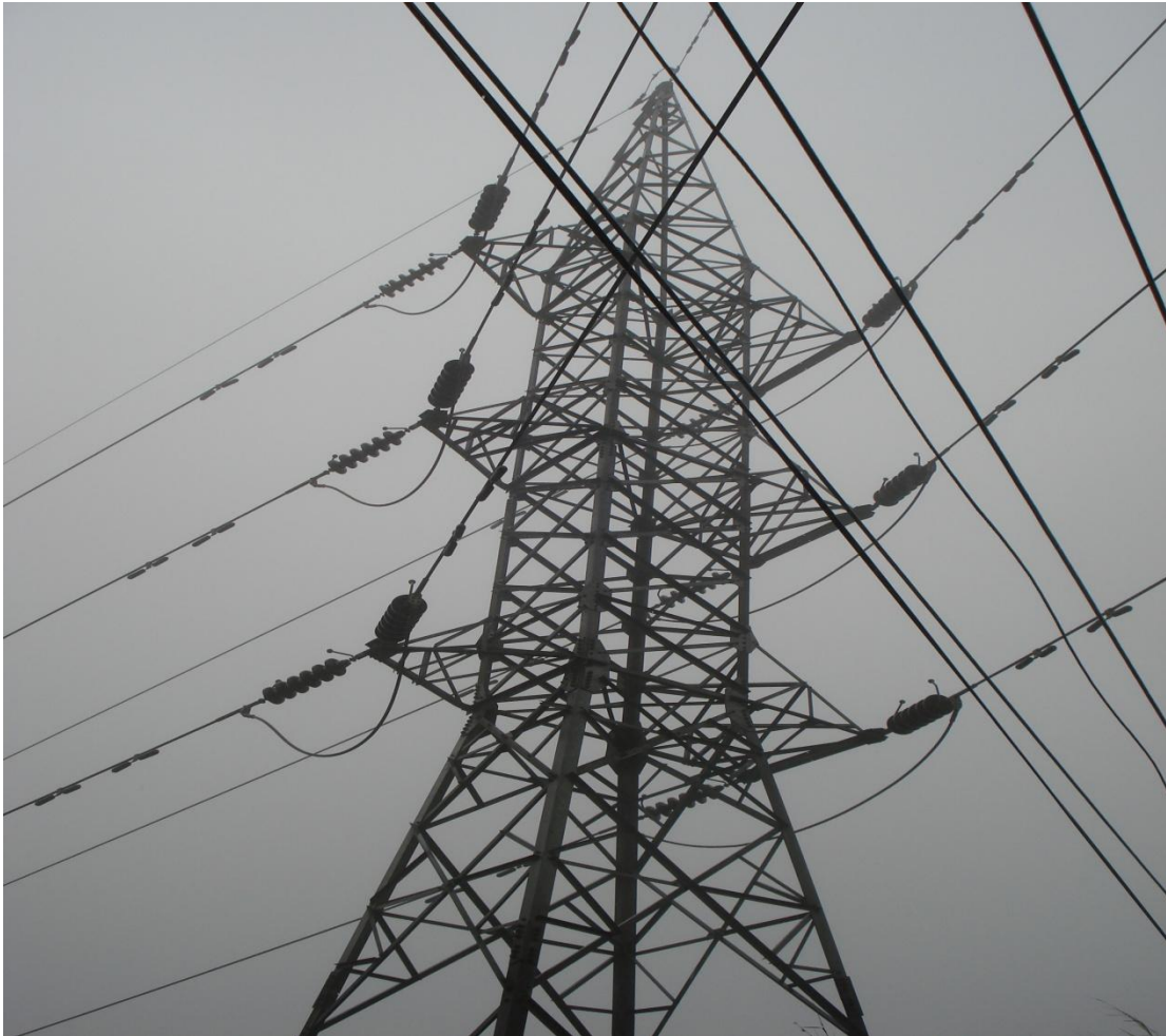
Torre 16R. Detalle línea de distribución de CADAFE.
