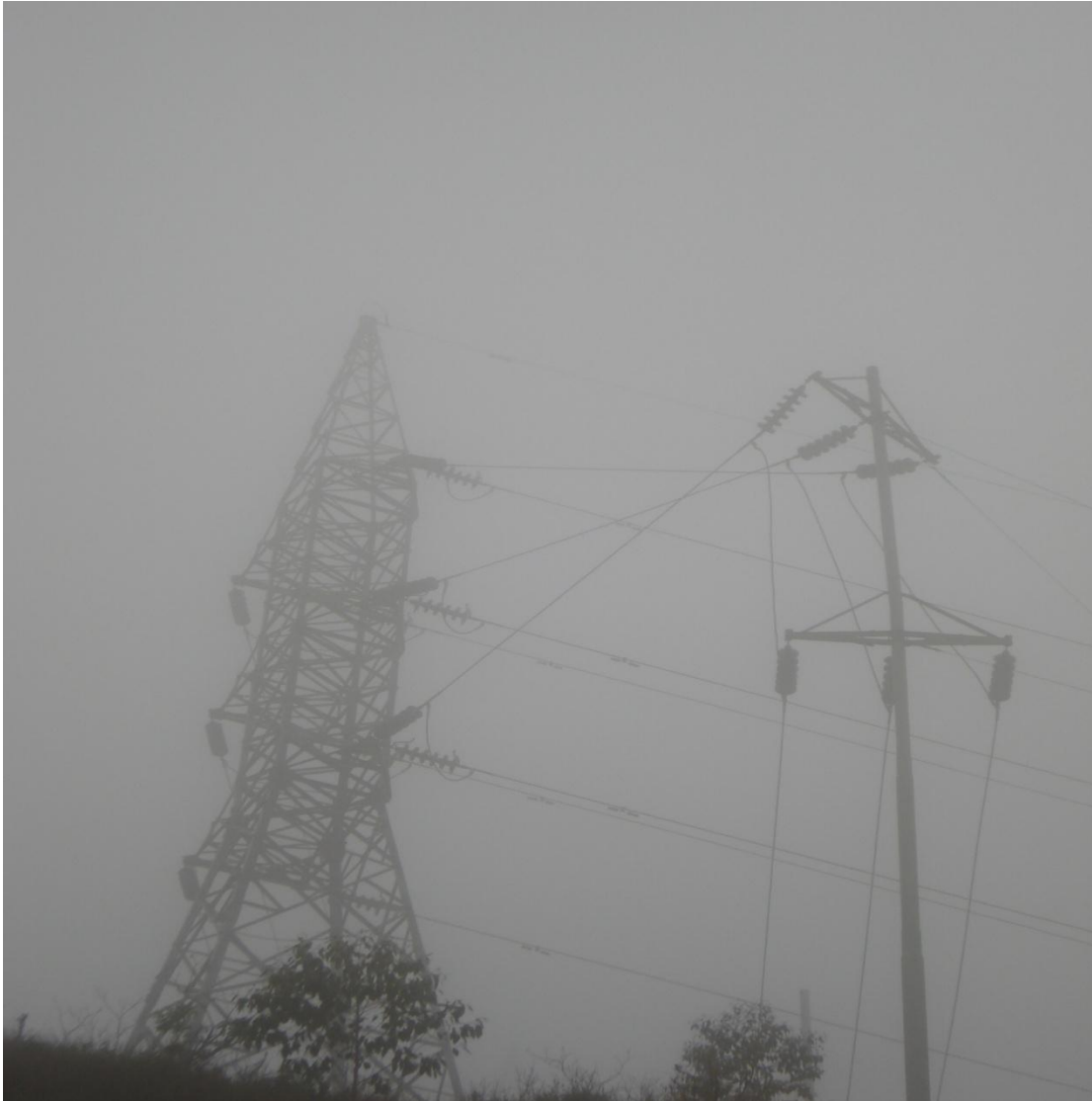
T-OFF S/E Carrizales, en la torre 8S.
