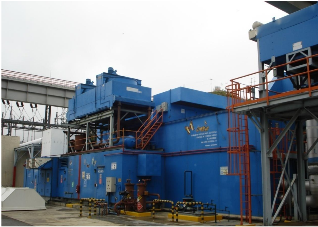
Vista lateral de la planta de generación OAM.
