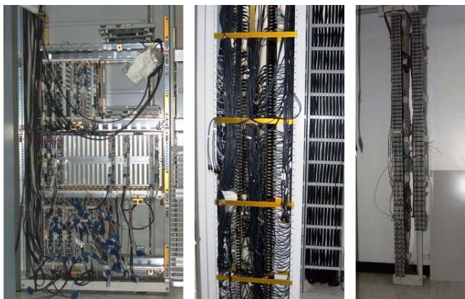
Figura 3.1 Equipo Terminal de Línea (izquierda), DDF para cable coaxial (centro) y Distribuidor Principal (derecha) en la central CANTV Caricuao
