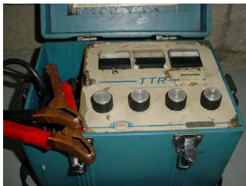
Figura 2.6 Equipo utilizado para la medición de la relación de transformación
