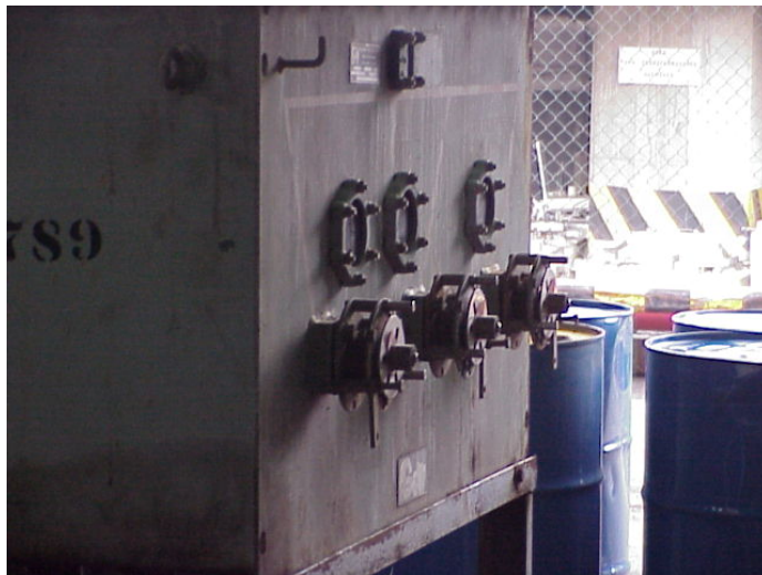
FIGURA 2.1 INSPECCION EXTERNA DEL EQUIPO
