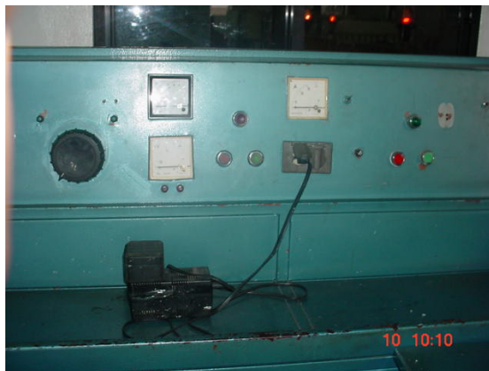
Figura 2.3 Consola en AC utilizado para la medición de tensión aplicada.
