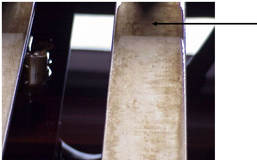
FIGURA 2.7 PRESENCIA DE CONTAMINANTES EN LAS PARTES METALICAS DEL SECCIONADOR
