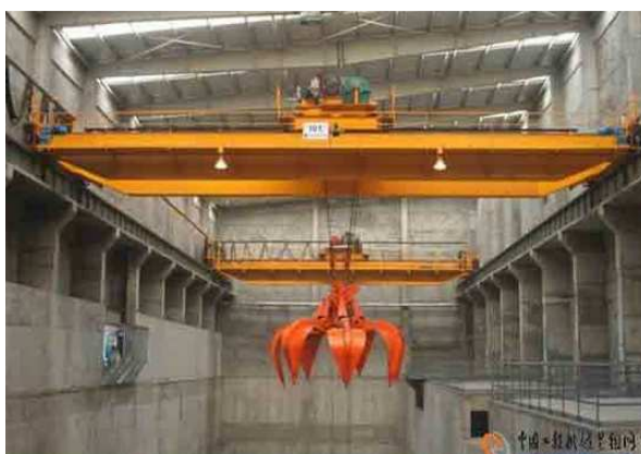
Figura 36. Puente grúa tipo pulpo.
