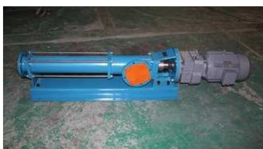
Figura 35. Bomba de extracción de lixiviados del foso
