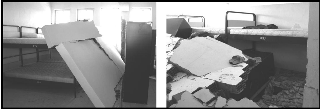
Figura 6. Colapso de mampostería no estructural no confinada a causa de un sismo. Tomado de Figure A4.12. Collapse of free-standing masonry walls onto beds in dormitory buildings in the 2003 Bingöl earthquake, Turkey. (imagen en línea), de GHI y OECD, 2004 .
