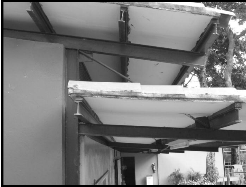
Fotografía C.31. Edificación 1. Alero de la Edificación 1 sostenido por tensores de barras macizas de acero de \frac{3}{4} ".
