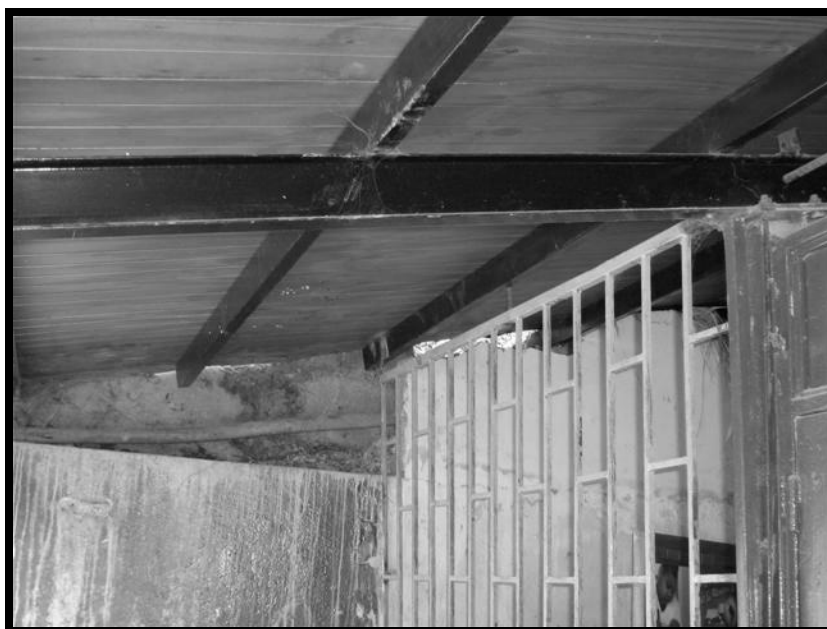
Fotografía C.12. Edificación 2. Tubos rectangulares 80x40 tipos CONDUVEN. Empleados como correas de la cubierta de techo y perfiles metálicos tipo IPN100 como vigas de carga. Base de la cubierta de techo de listones de madera impermeabilizados. La estructura está adosada a una pared en su fachada Norte.
