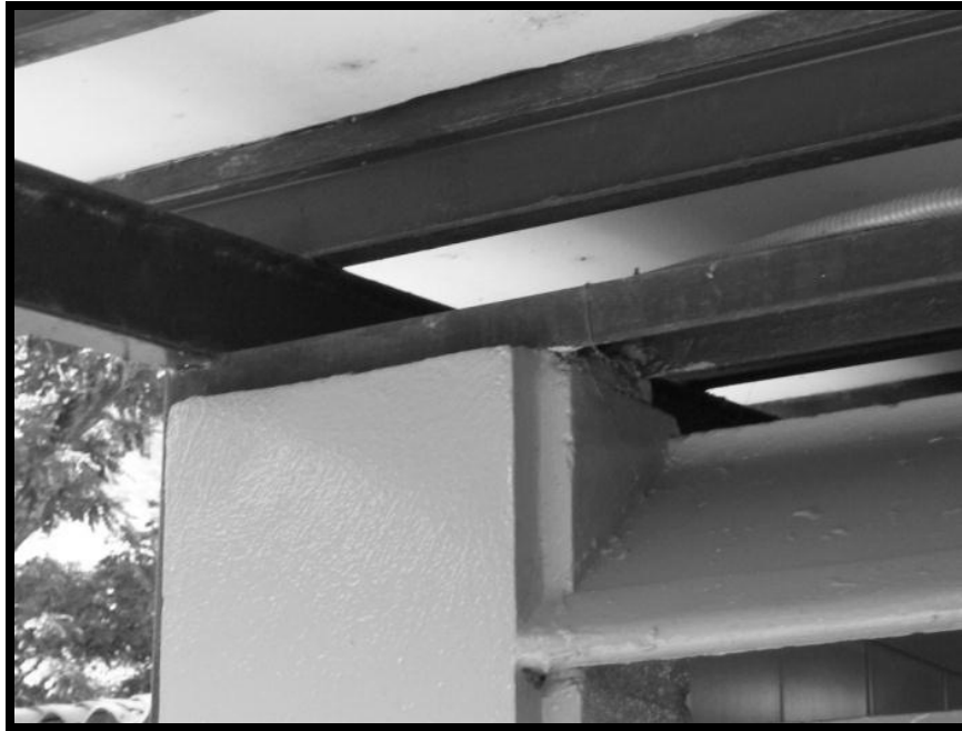
Fotografía C.27. Edificación 1. Detalle de la disposición horizontal de la viga de superior del extremo del baño anexo. Fachada Oeste.
