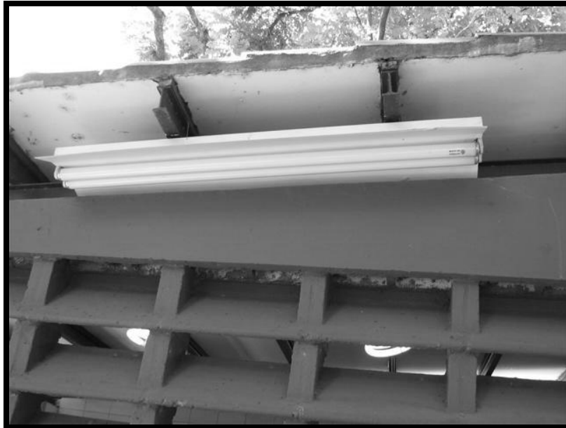
Fotografía C.25. Edificación 1. Bloques de ventilación del baño anexo a la Edificación 1 (Fachada Sur). En toda la escuela se observaron lámparas sin protección para el posible desprendimiento de los bombillos fluorescentes.
