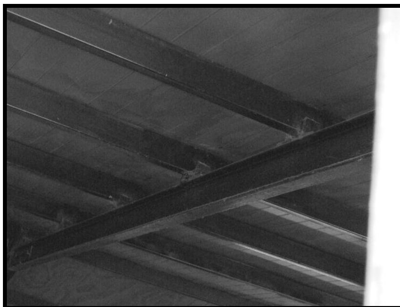
Fotografía C.8. Edificación 2. Correas de tubos rectangulares 80x40 tipo CONDUVEN y vigas de carga de perfiles metálicos tipo IPN100.
