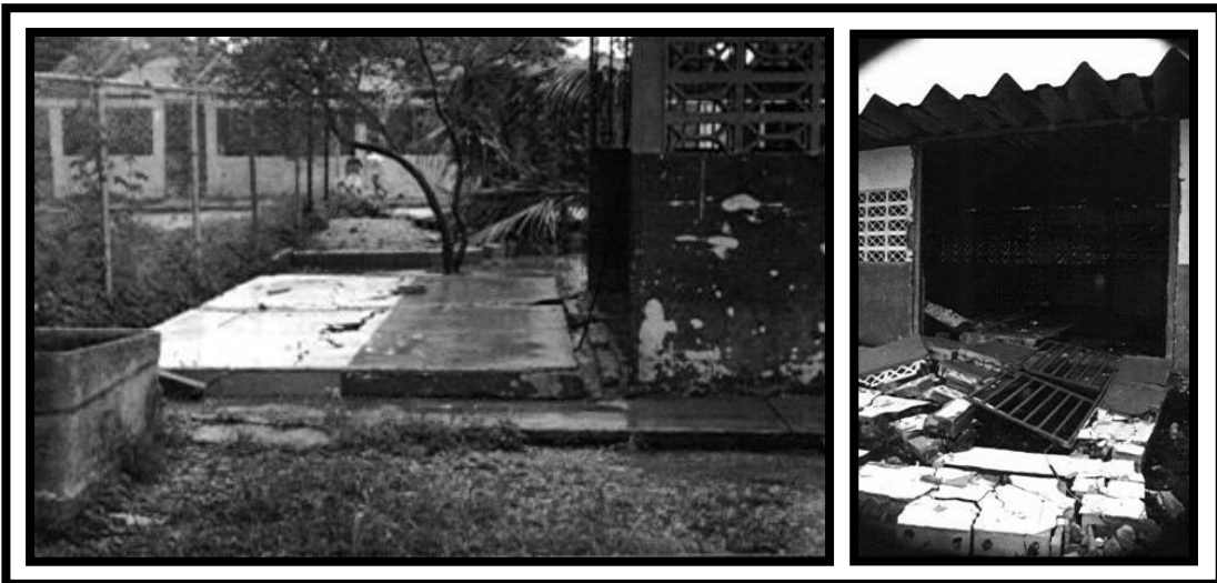
Figura 7. Colapso de mampostería no estructural confinada a causa de un sismo. Tomadas del documento informativo Planteles Construidos con Sistema "R" (de izq. a der.: imágenes del G.E. Matías Parra Alcalá, pp.3-4 respect.) de FEDE, 2001, octubre, (s.l.) .
