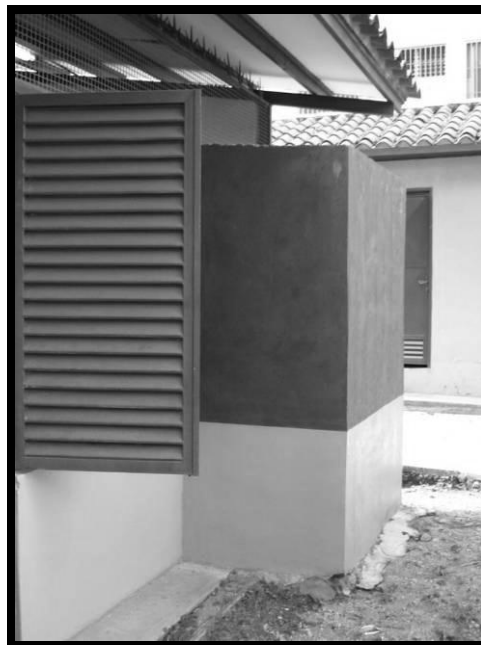
Fotografía C.36. Edificación 1. Apéndices (tipo closet) existentes en los extremos de la Fachada Este. Extremo Norte-Este.
