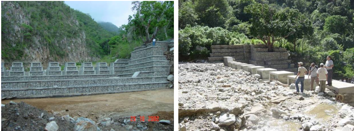
Foto 17. Presa abierta ranurada en el río El Cojo: Vista desde aguas abajo después de su construcción en Octubre 2002 (izquierda). Vista de la acumulación de sedimentos gruesos aguas arriba del dique después de la tormenta de Febrero 2005 (derecha). (Tomada por: El Instituto de Mecánica de los Fluidos).
