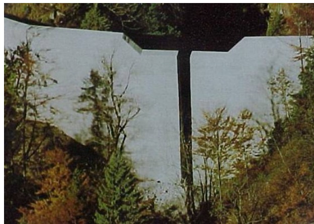
Foto 3. Presa con ranura de paredes verticales en Austria (Tomado de: "Presas de corrección de Torrentes y Retención de Sedimentos", Suárez V. Luís M. Pág. 10-7)
