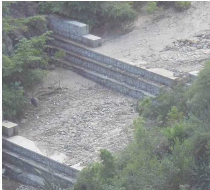
Foto 11. Presa cerrada de gaviones en Venezuela funcionando en condiciones hidráulicas normales (Tomada por: Instituto de Mecánica de los Fluidos, Febrero de 2.005)
