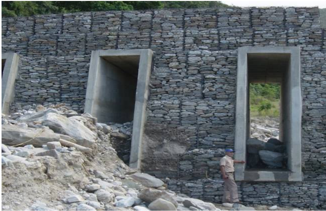
Foto 12. Presa de Ventana en Venezuela funcionando en condiciones hidráulicas normales (Tomada por: El Instituto de Mecánica de los Fluidos en Febrero de 2.005)
