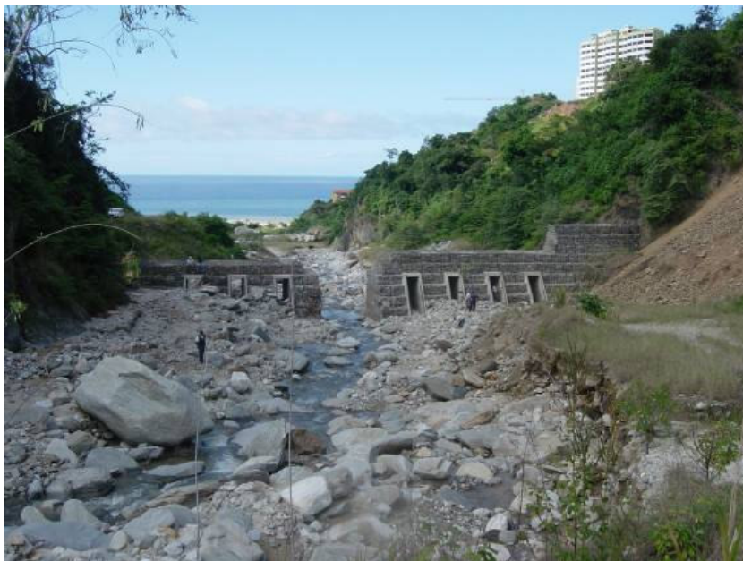
Foto 19. Vista de la presa de Camurí Chico desde aguas arriba. (Tomada por: El Instituto de Mecánica de los Fluidos)
