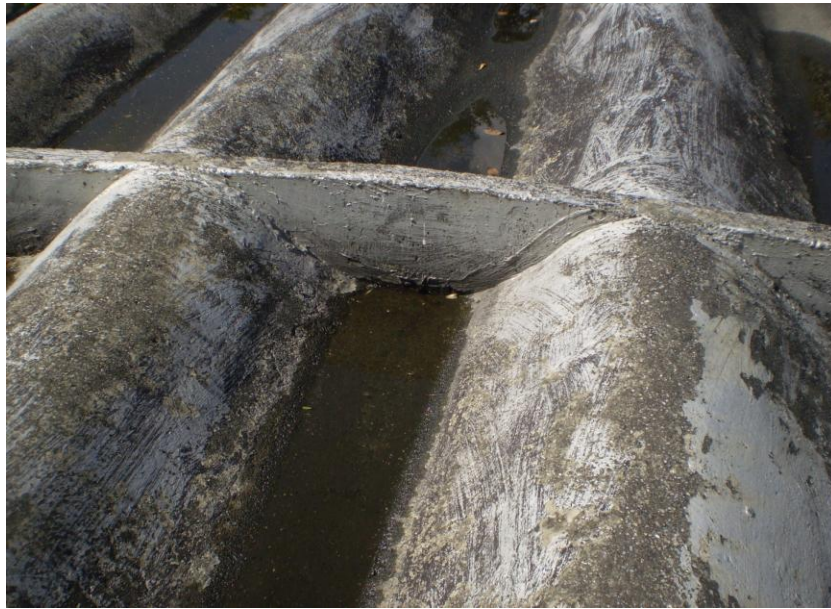
Foto 4.5.5. Formación de pozos en la azotea.
