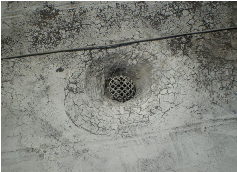
Foto 4.6.5. Drenaje del techo libre y deterioro del acabado de impermeabilización alrededor.
