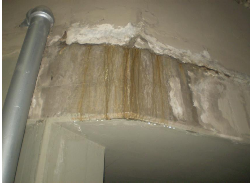
Foto 4.8.16. Filtración de agua a través de la grieta horas después del derrame de agua en el piso de la piscina.
