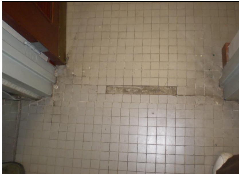
Foto 4.8.8: Fisuras observadas en la losa de piso (área de junta), nivel 1.
