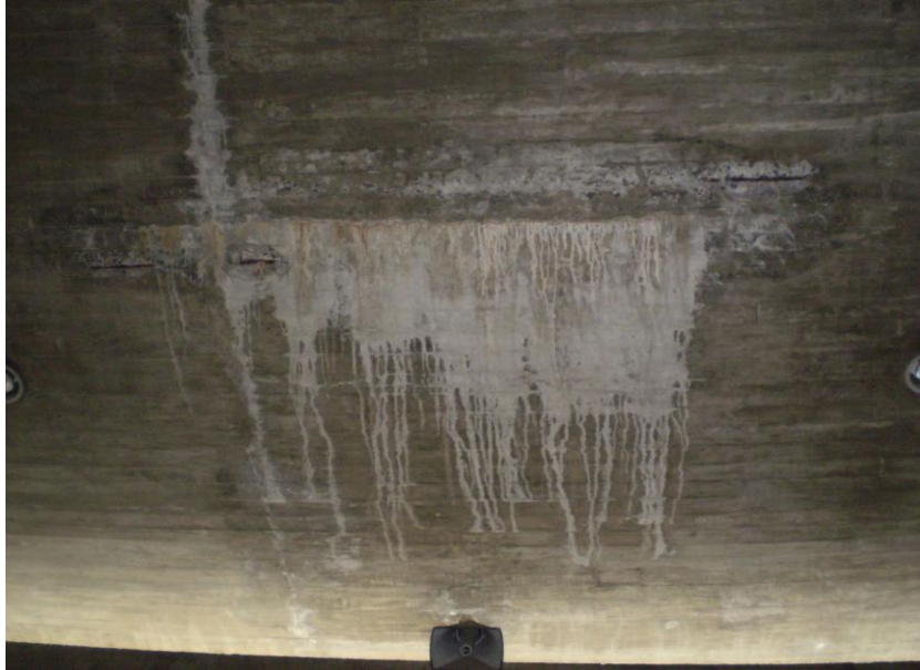
Foto 4.6.2. Evidencia de filtraciones en la losa
