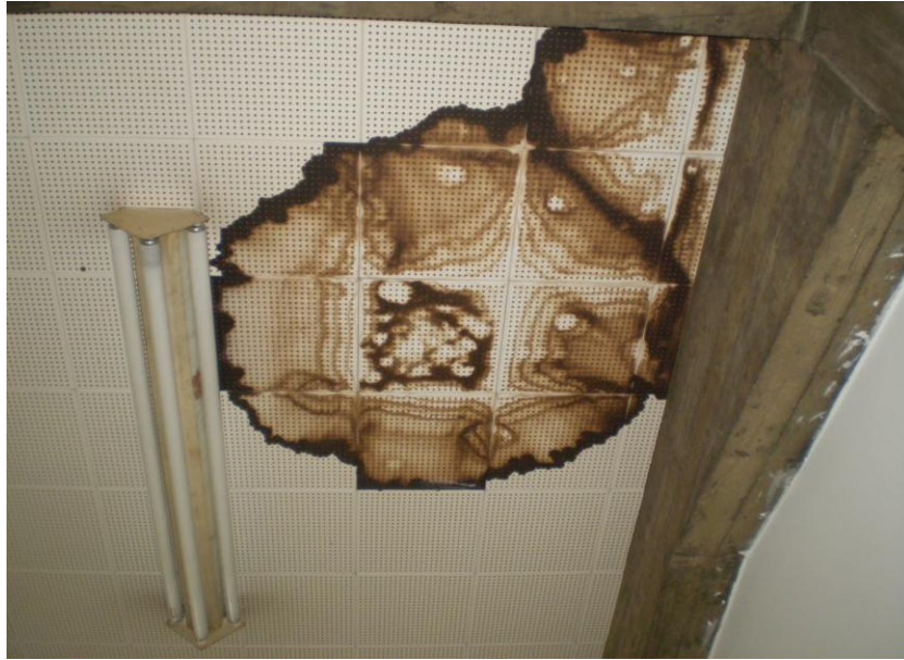
Foto 4.9.7. Mancha de filtración en un aula del piso 7
