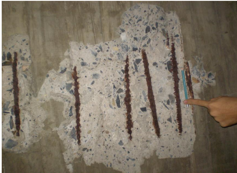
Foto 4.6.7. Barras de acero de refuerzo corroídas
