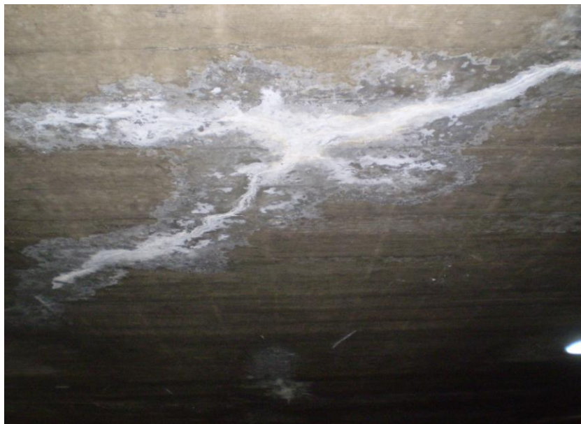
Foto 4.9.3. Eflorescencias en la losa de techo del anexo.
