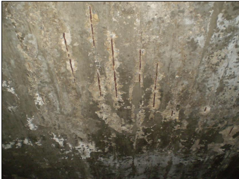
Foto 4.1.3. Corrosión del acero de refuerzo de la losa de techo de la sala de entrada.
