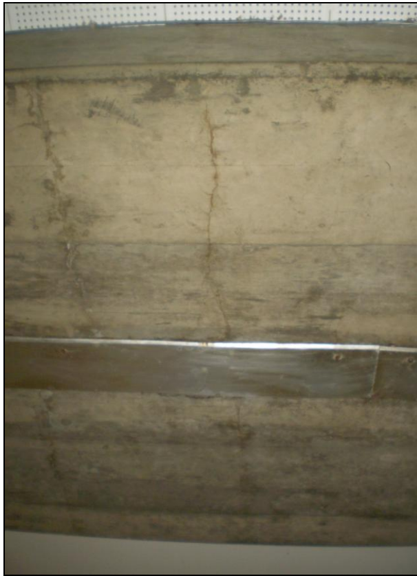
Foto 4.8.7: Fisuras observadas en viga de junta, nivel 1.
