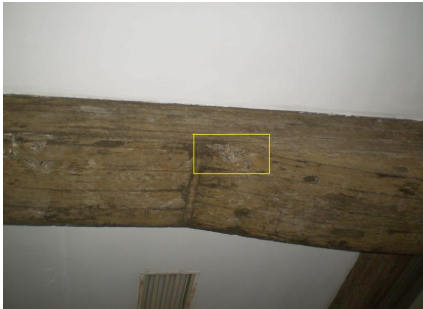
Foto 4.9.18. Viga golpeada en el piso 6.
