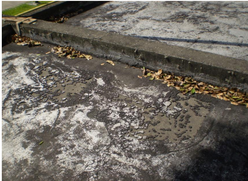
Foto 4.2.8. Desprendimiento del acabado de impermeabilización
