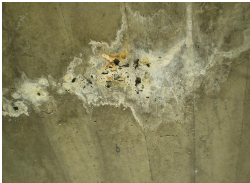
Foto 4.2.4. Eflorescencias y disgregación en la losa de techo
