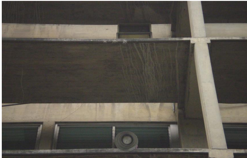
Foto 4.7.7. Manchas en el antepecho debido al goteo de equipos de aire acondicionado
