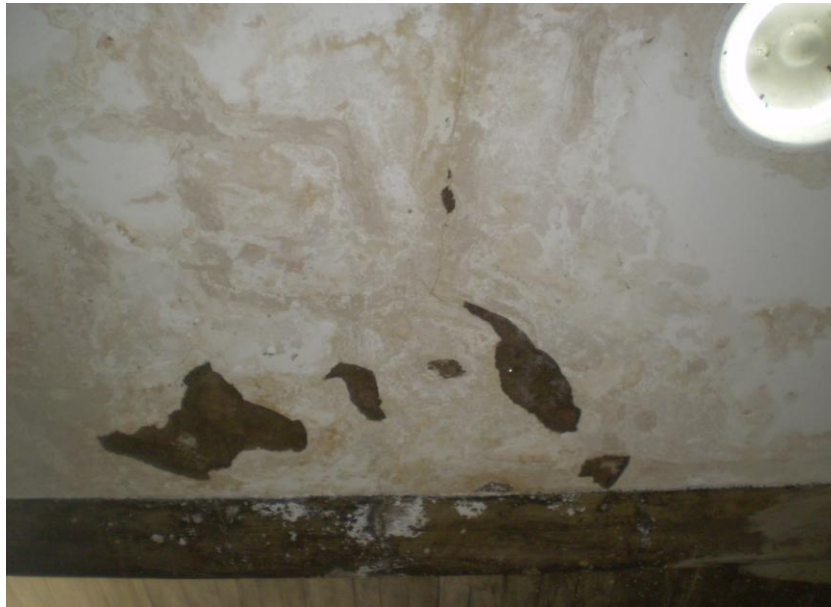
Foto 4.9.2. Manchas de filtraciones y pérdida de recubrimiento en la losa de techo
