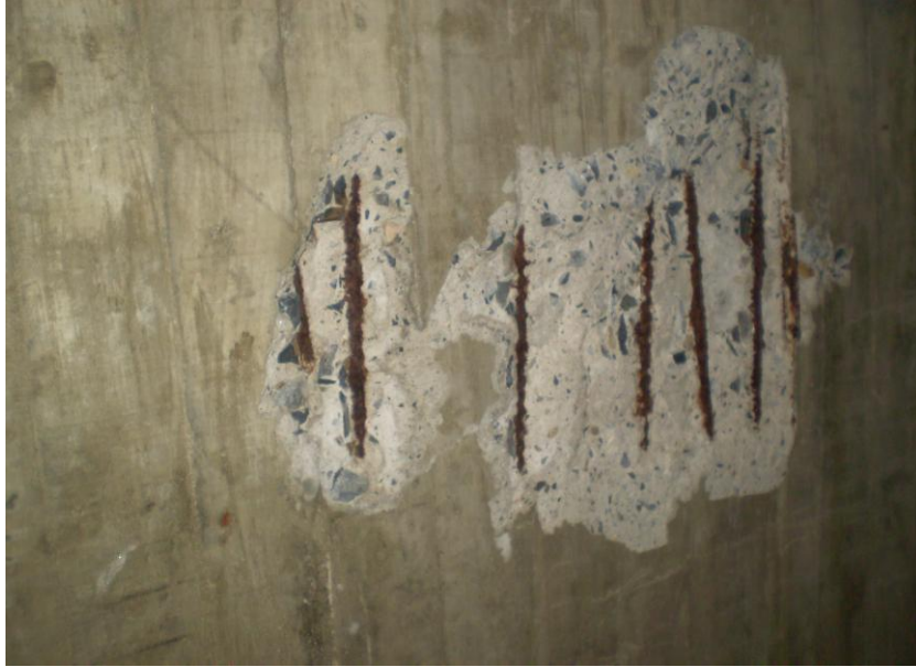
Foto 4.6.4. Acero de refuerzo corroído y gran pérdida de recubrimiento en la losa
