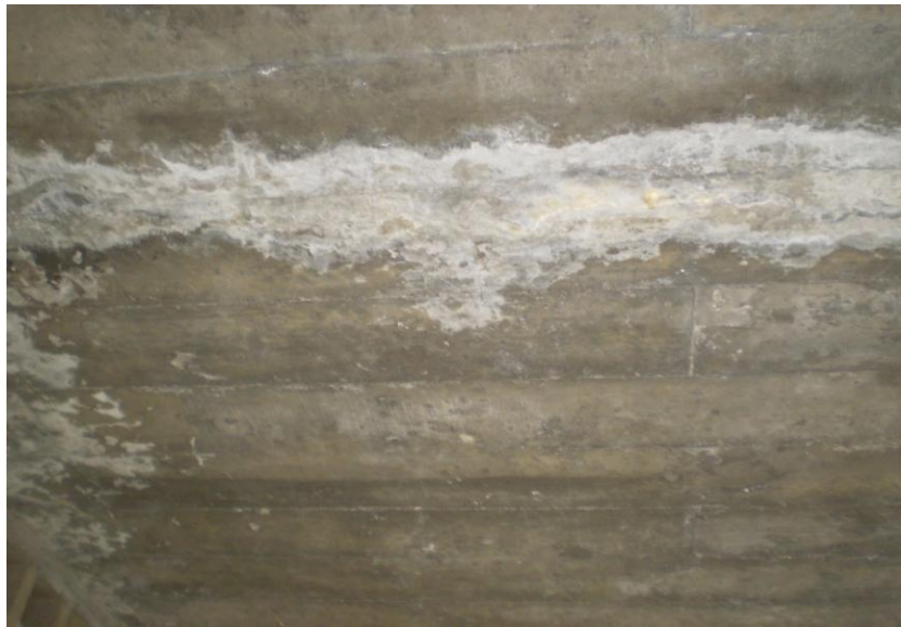
Foto 4.2.2. Eflorescencias en la losa de techo
