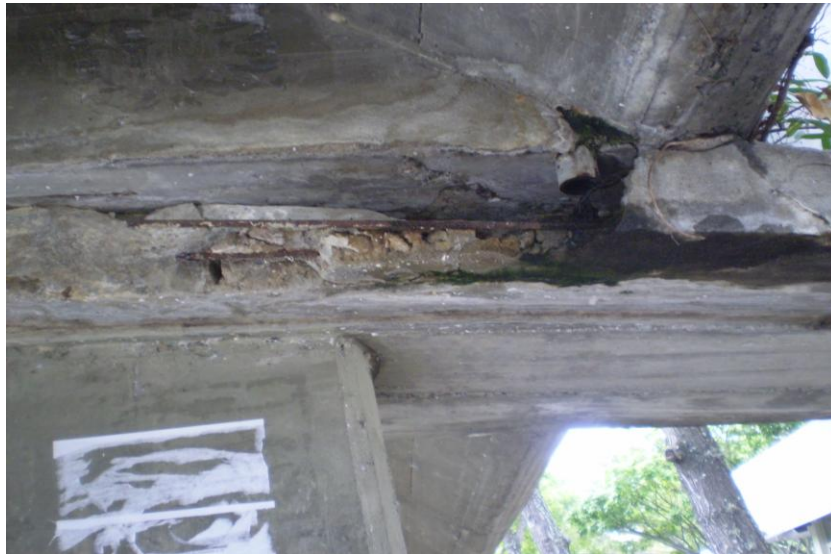
Foto 4.5.2. Desprendimiento del elemento de drenaje adosado a la viga
