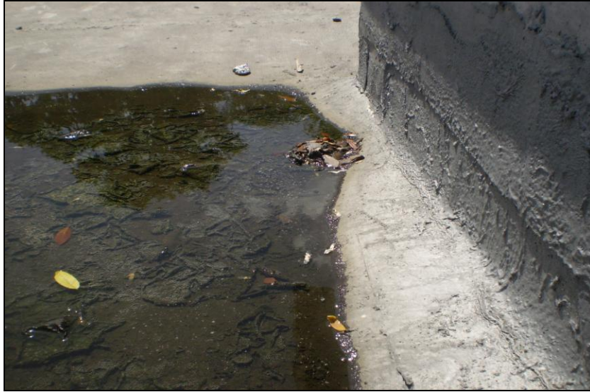
Foto 4.4.7. Formación de pozos debido a drenaje obstruido
