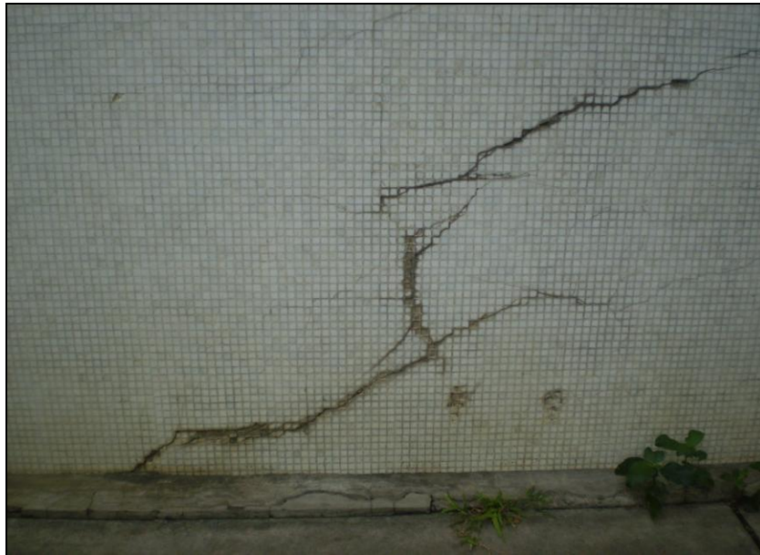
Foto 4.8.5 Agrietamiento vertical en la fachada sur.
