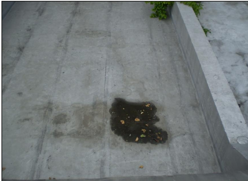
Foto 4.1.8. Formación de pozos en la azotea.
