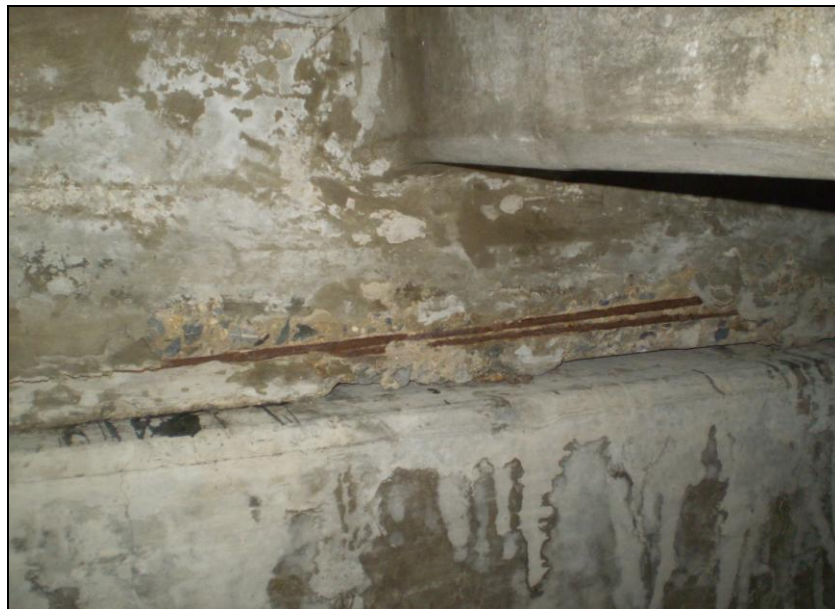
Foto 4.1.2. Armadura expuesta y corroída en viga de la sala de entrada.
