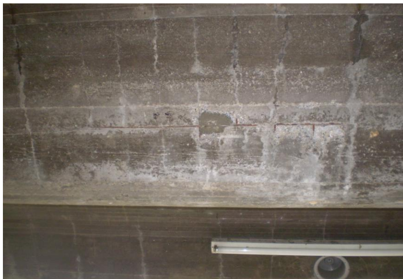
Foto 4.5.3. Armadura expuesta en la losa.
