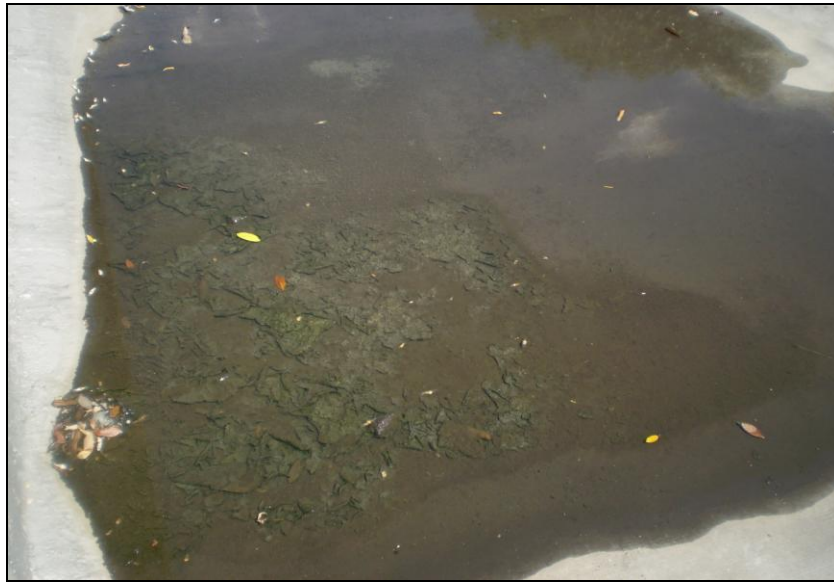
Foto 4.4.5. Agua estancada en la azotea del módulo de escaleras.
