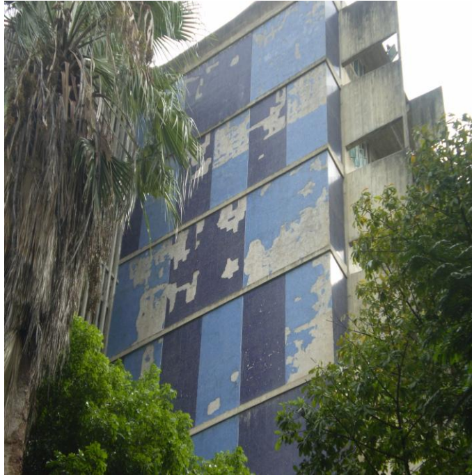
Foto 4.9.11. Desprendimiento del mosaico vitrificado en la fachada este.
