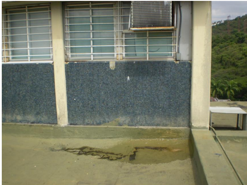
Foto 4.7.5. Formación de pozos debido a goteo del aire acondicionado
