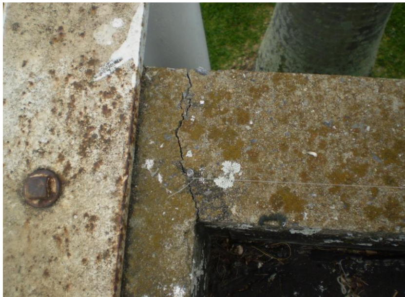
Foto 4.2.6. Fisura en la losa a la altura del apoyo.
