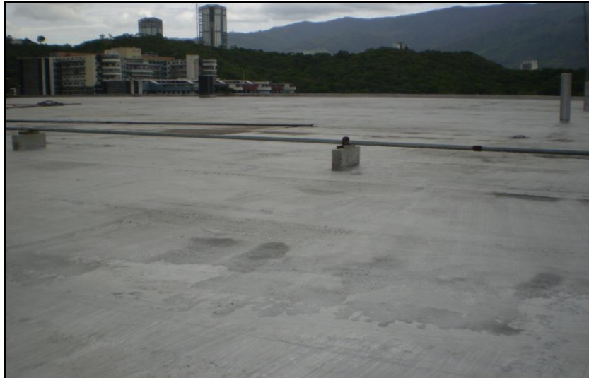
Foto 4.1.12. Estado de la impermeabilización de la azotea de la torre.
