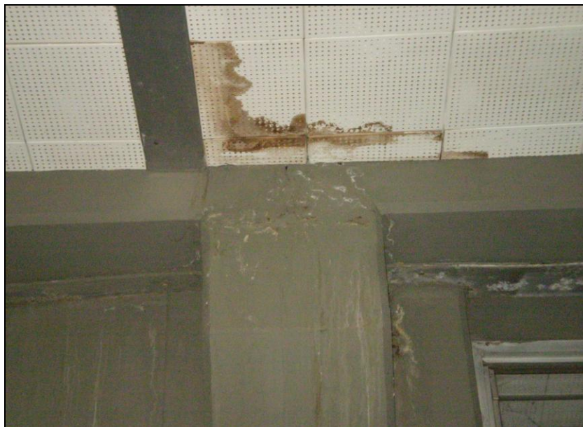
Foto 4.8.2. Agrietamientos y filtraciones en la ménsula.
