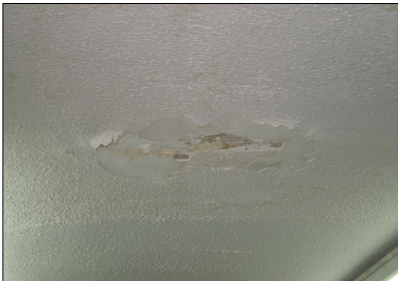
Foto 4.1.4. Indicios de filtraciones en el techo de la Biblioteca.
