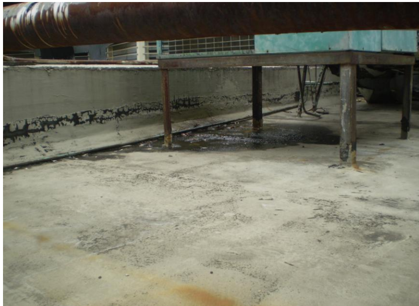
Foto 4.9.10. Formación de pozos debido al mal desagüe de un equipo de aire acondicionado.
