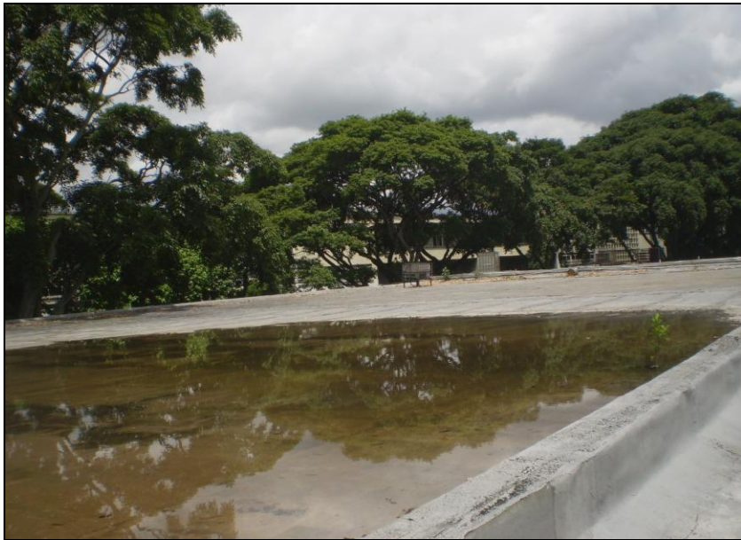
Foto 4.8.12. Gran cantidad de agua estancada en la azotea.
