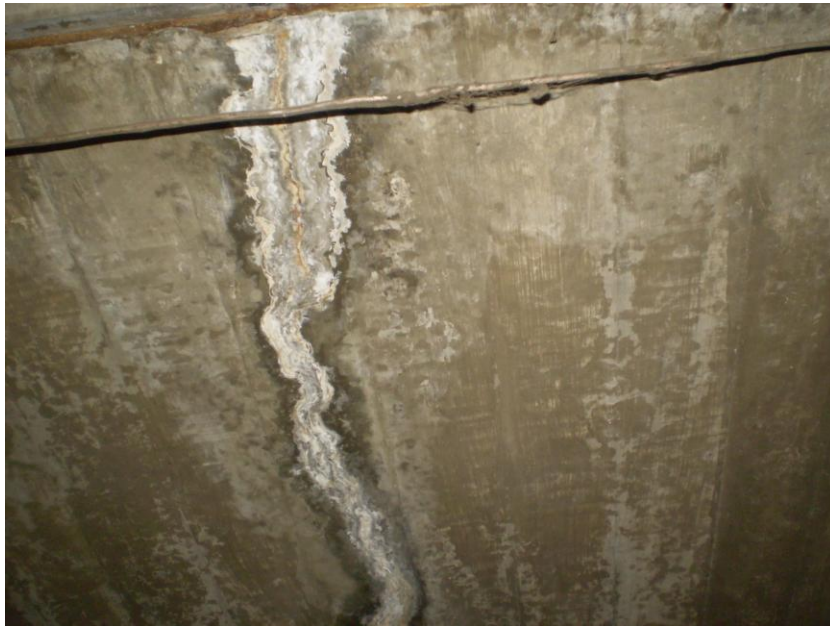
Foto 4.3.8. Evidencia de filtraciones en la losa de techo.
