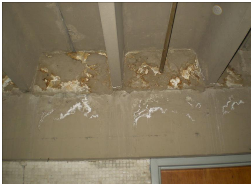
Foto 4.4.4. Indicios de filtraciones en el techo del módulo de escaleras
