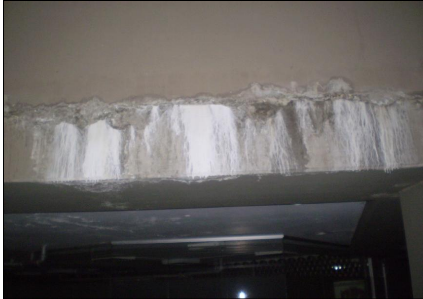
Foto 4.8.3. Agrietamiento y eflorescencia entre la viga y la pared apoyada.
