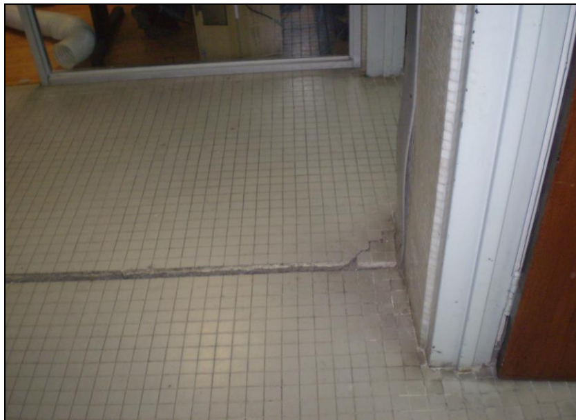
Foto 4.8.6. Desnivel de la losa en la junta entre los dos cuerpos.
