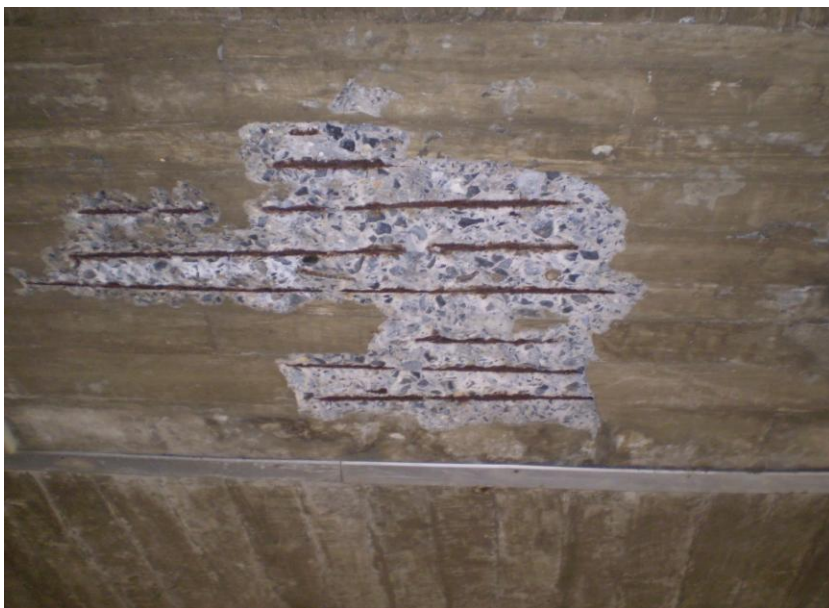
Foto 4.3.6. Acero de refuerzo expuesto y corroído en la losa de techo
