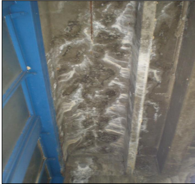
Foto 4.4.2. Eflorescencias en el sector exterior este del edificio.
