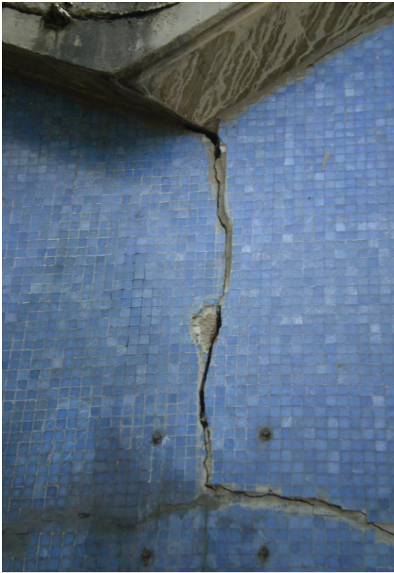
Foto 4.9.12. Fisura 10. Fachada oeste
