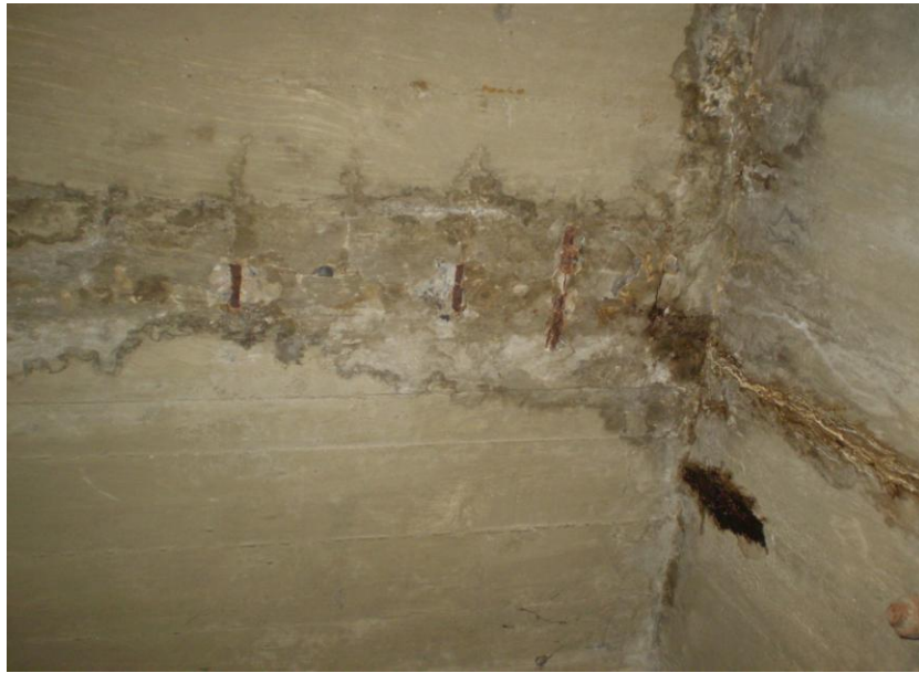
Foto 4.6.8. Filtraciones en la zona de iluminación del Aula Magna
