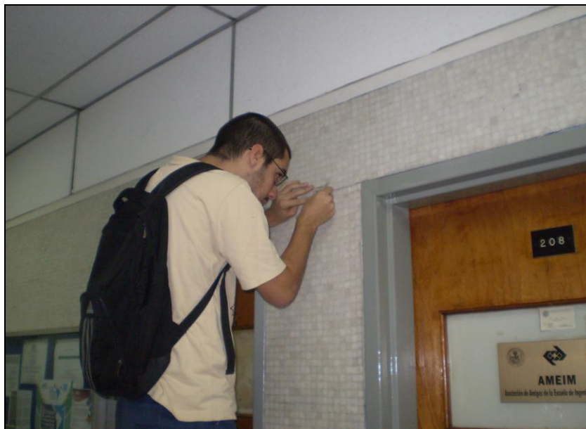
Foto 4.4.14: Proceso de medición de grietas
