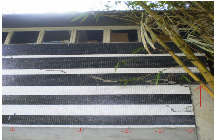
Foto 4.9.17. Pared de la biblioteca fracturada debido a las solicitaciones mostradas.
