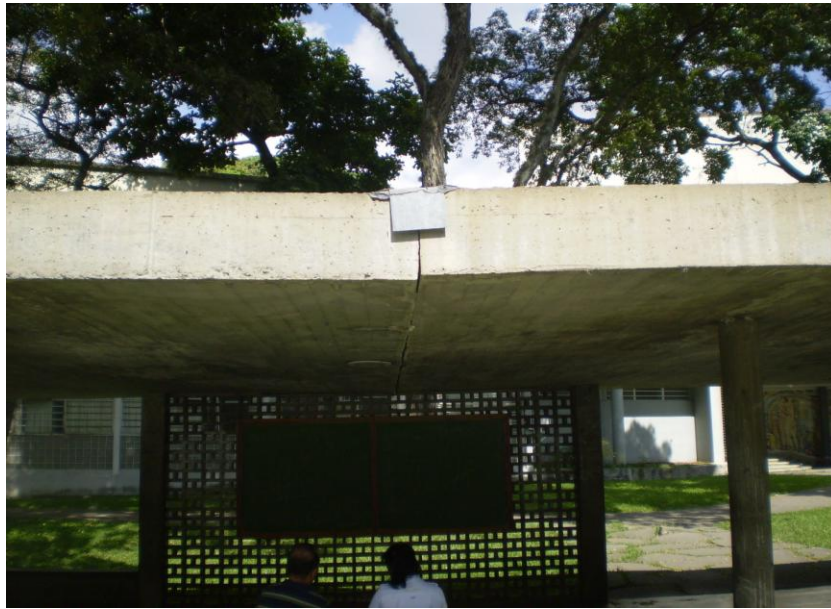
Foto 4.2.5. Deflexión de la losa en los volados.
