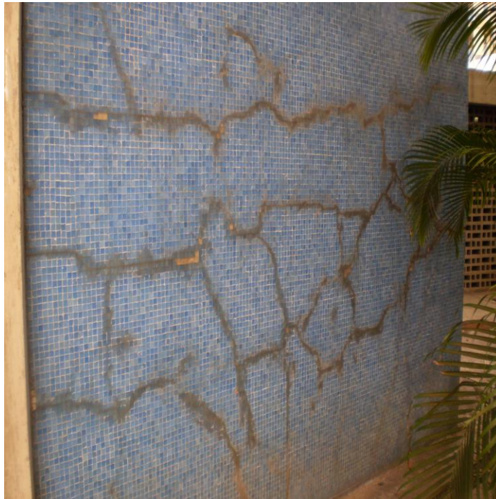
Foto 4.9.14. Grietas selladas con silicona.
