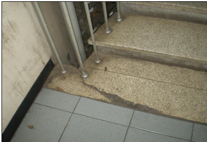
Foto 4.4.3. Grietas en la unión losa-escalera
