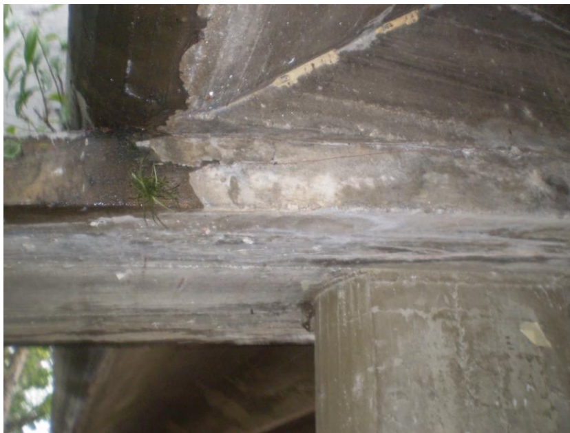
Foto 4.5.10. Presencia de vegetación en el apoyo de la losa.
