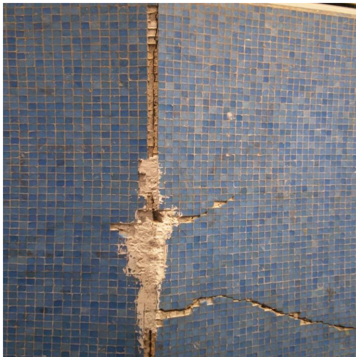
Foto 4.9.15. Modelo de fisuras de la pared norte del anexo. Vertical y Horizontal.
