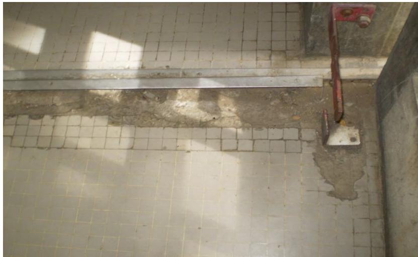
Foto 4.9.5. Desprendimiento del acabado de piso en la junta.
