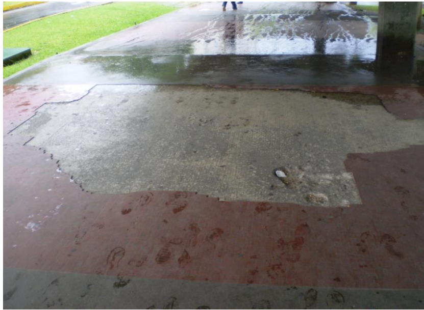
Foto 4.5.4. Desprendimiento del acabado de piso.
