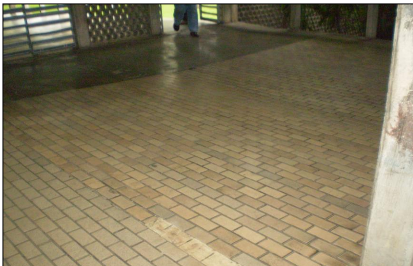
Foto 4.1.11. Losa de la sala de entrada flectada significativamente.
