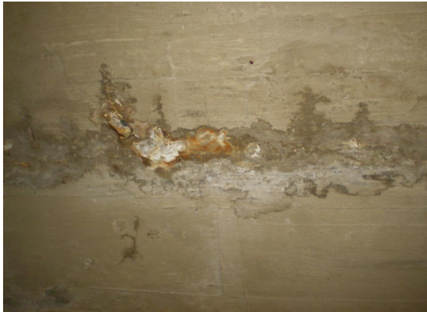
Foto 4.6.9. Eflorescencias y filtraciones en la zona de iluminación del Aula Magna
