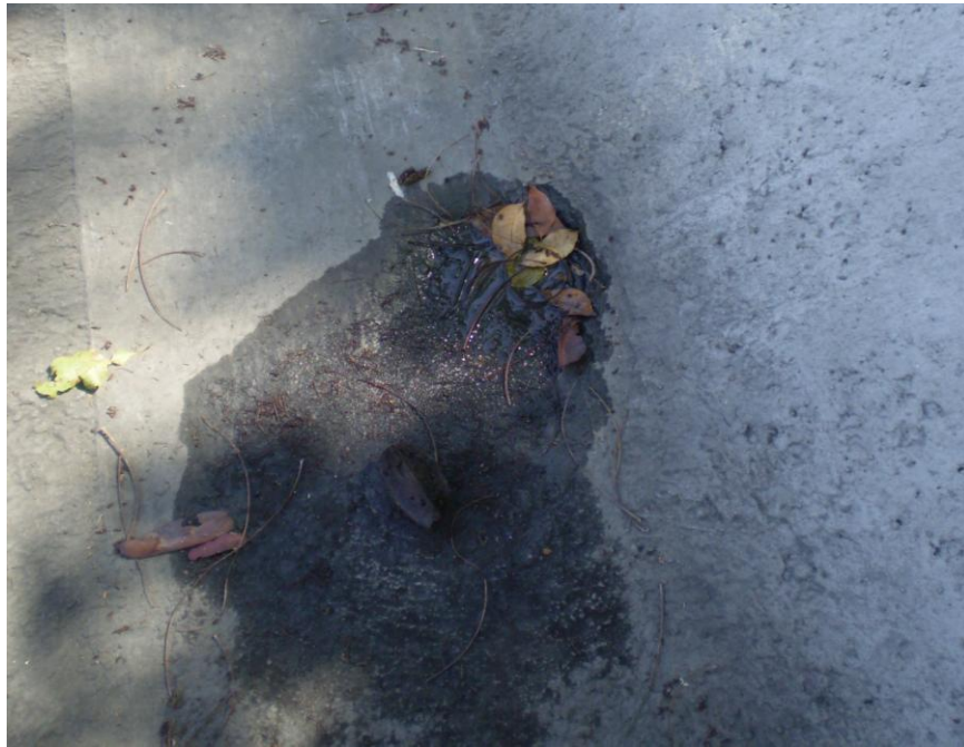
Foto 4.5.7. Drenaje obstruido por vegetación
