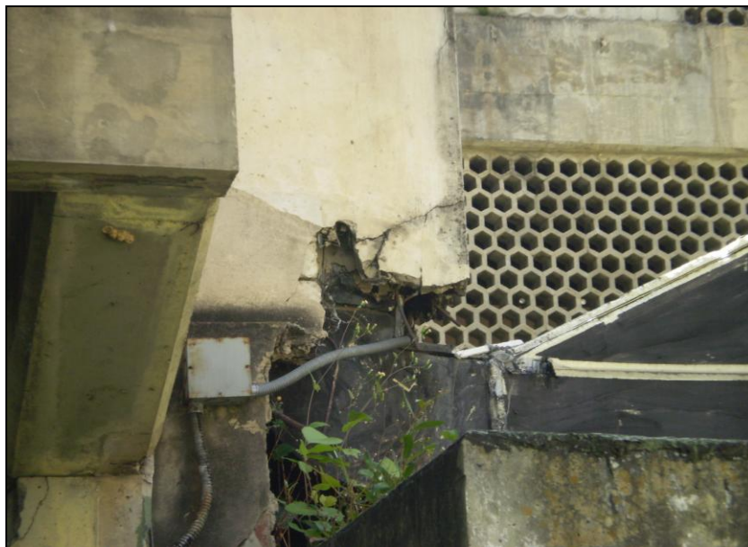
Foto 4.4.6: Deterioro ubicado en ducto de aire en fachada Oeste.
