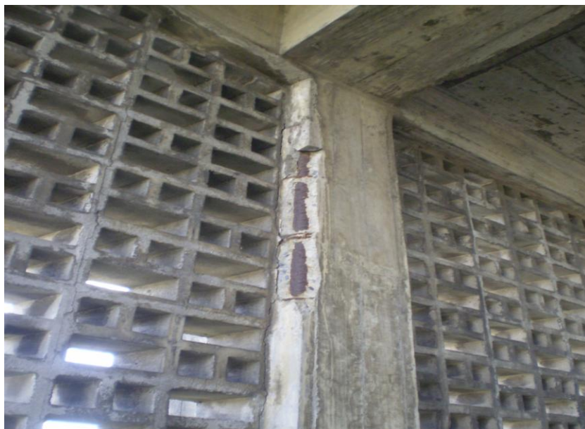
Foto 4.9.4. Pérdida de recubrimiento y acero corroído en las escaleras externas. Piso 8
