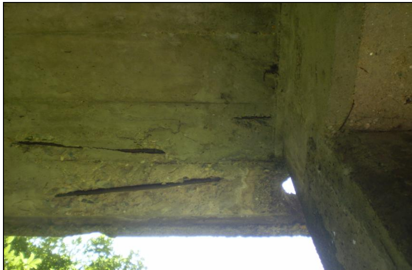
Foto 4.1.6. Armadura expuesta y corroído en la losa de techo del pasillo de entrada
