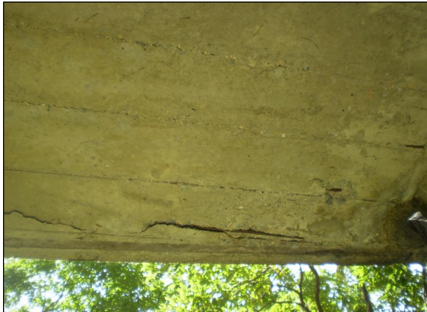
Foto 4.1.7. Pérdida de recubrimiento en la losa de techo del pasillo de entrada
