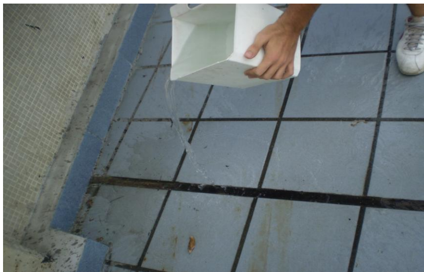
Foto 4.8.15. Derrame de agua sin colorante en las juntas del piso de la piscina.
