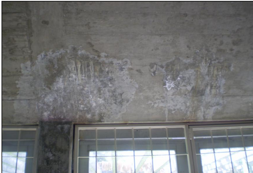
Foto 4.1.10. Eflorescencias en la parte interna de la losa de techo de la Biblioteca.
