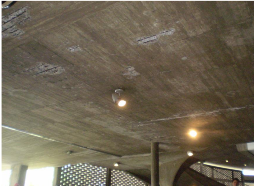
Foto 4.3.2. Sector de la losa de techo más afectado por pérdida de recubrimiento, armadura corroída y expuesta, eflorescencias y manchas de filtraciones
