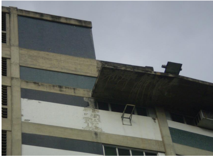
Foto 4.7.6. Desprendimiento localizado del mosaico vitrificado.
