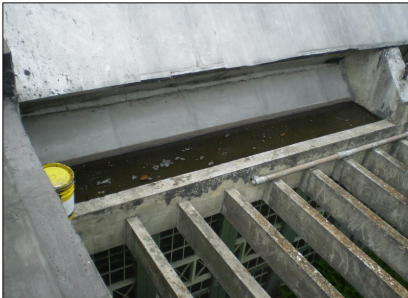
Foto 4.1.9. Masa de agua acumulada en el techo de la biblioteca.
