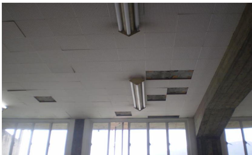
Foto 4.9.6. Desprendimiento del acabado de techo en un aula.
