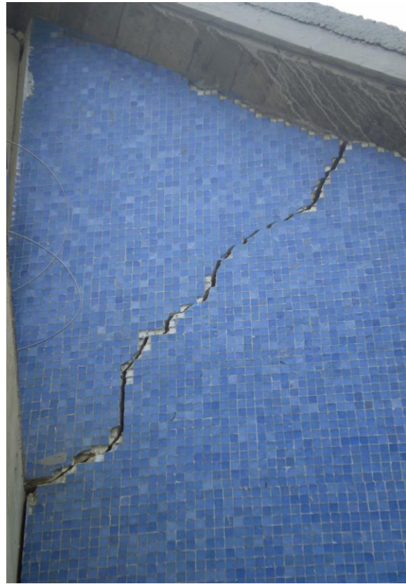
Foto 4.9.13. Fisura 34. Fachada este
