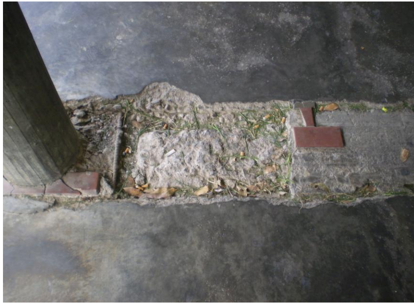
Foto 4.2.7. Desprendimiento del acabado de piso.
