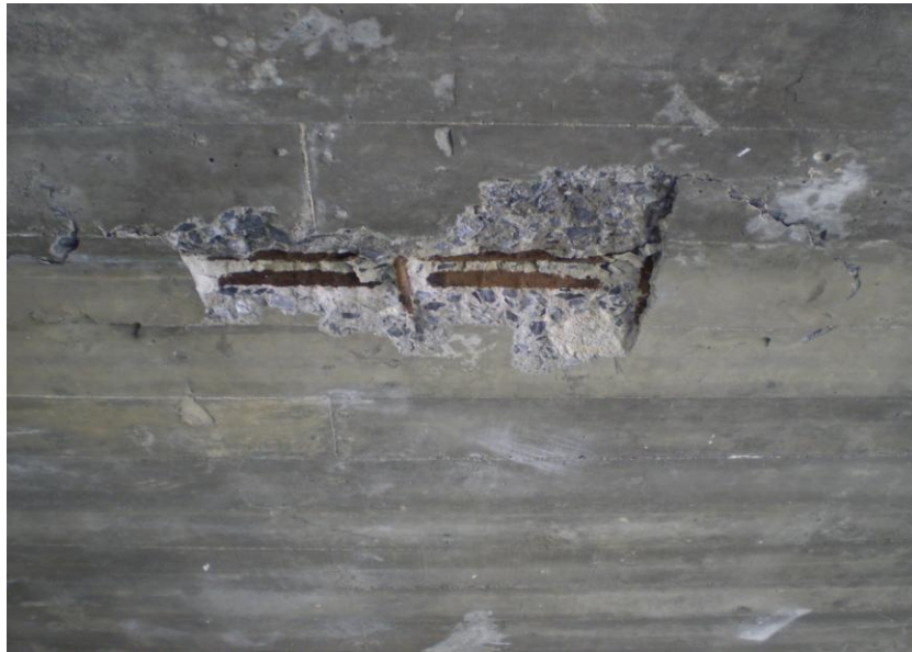
Foto 4.2.3 Perdida de recubrimiento y armadura expuesta y corroído en la losa de techo
