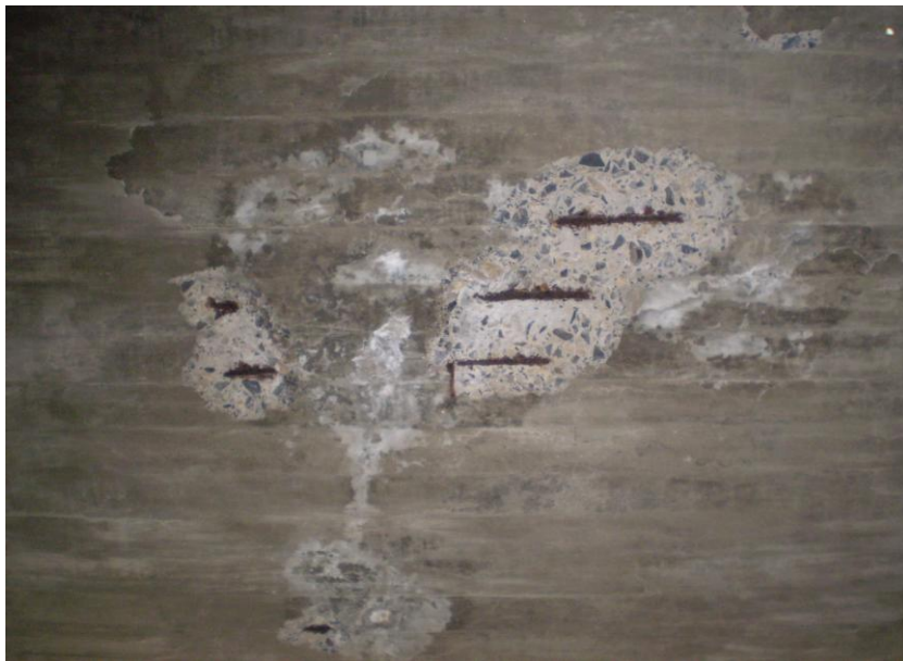
Foto 4.6.3. Perdida de recubrimiento y acero corroído en la losa.
