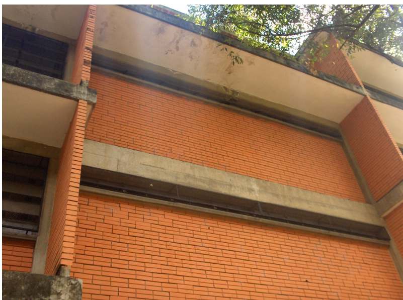
Imagen 018. Discontinuidad del volado en la zona de los baños en fachadas norte y sur
