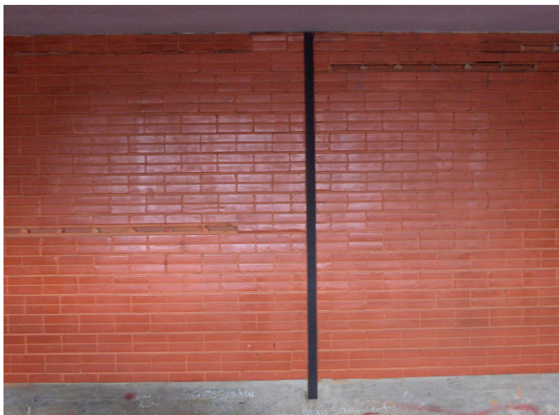
Imagen 014. Machón de acero en paredes completas de pórticos longitudinales (salones y escaleras).
