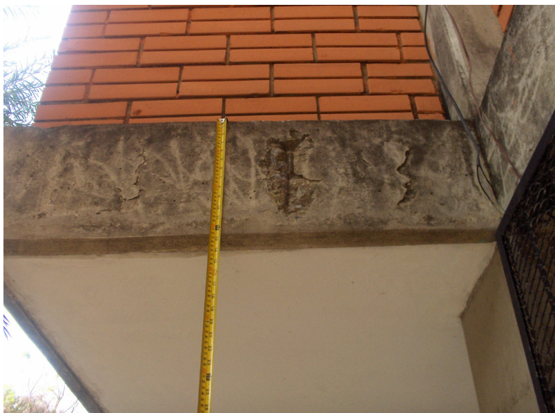
Imagen 022. Daños menores en la estructura. Presencia de estribos de viga plana en volado dirección norte-sur.
