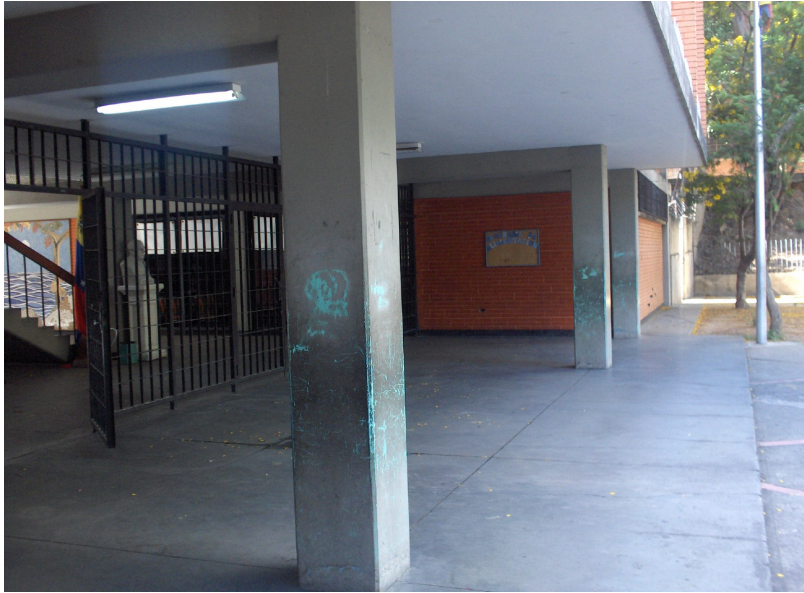
Imagen 019. Fachada principal. Viga alta no se extiende hasta el volado.
