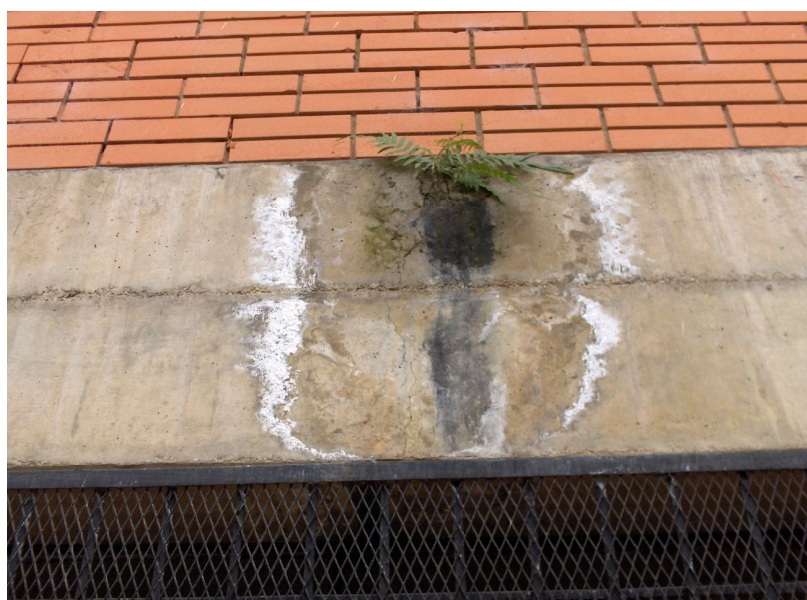
Imagen 024. Daños menores en la estructura producto de filtración.
