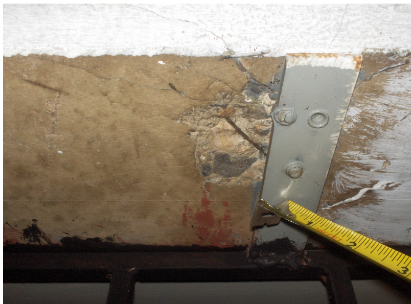
Imagen 023. Daños menores en la estructura. Viga alta en aula de segunda planta.
