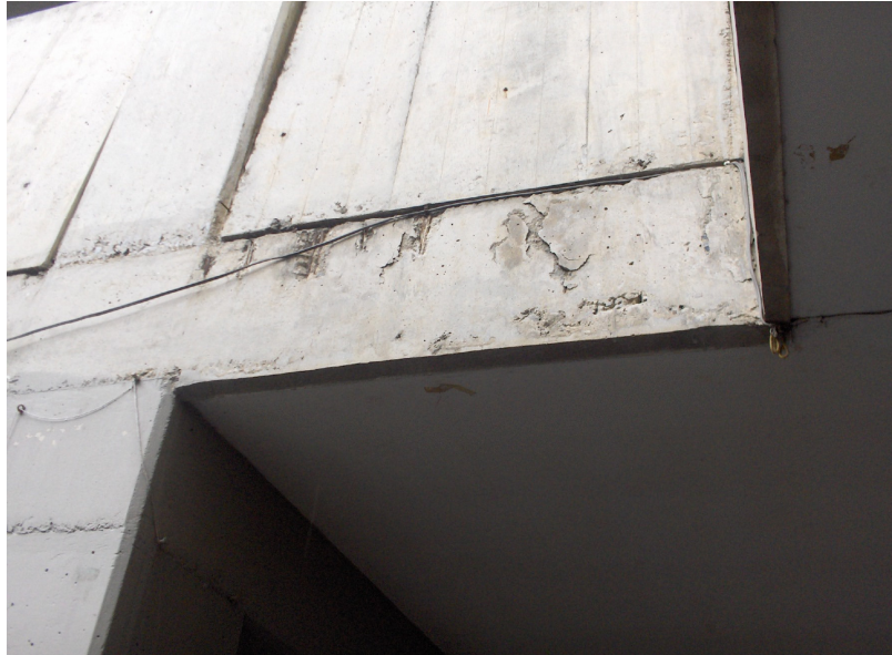
Imagen 021. Daños menores en la estructura. Presencia de estribos de viga plana en dirección norte-sur.
