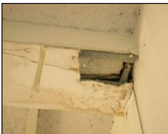
Imagen A.9. Junta estructural y viga falsa deteriorada. Planta alta. Patio Venezuela. Norte.
