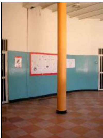
Imagen A.33. Columna circular, Planta alta, Patio Venezuela Norte. Vista al Oeste.
