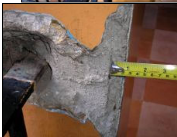
Imagen A.31. Columna Patio América, esquina Sur-Oeste. Planta baja. Vista al Sur.
