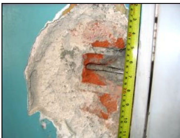
Imagen 29. Daño en el muro, cabilla, ladrillo macizo de arcilla
