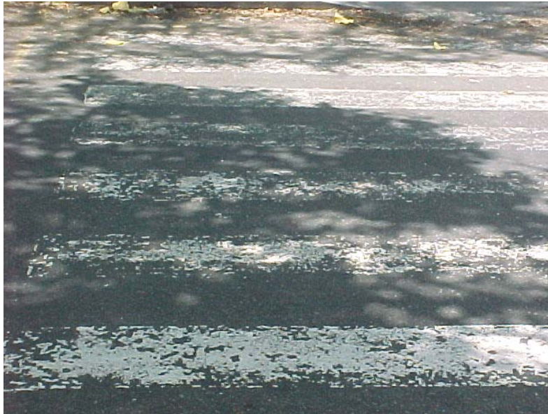
Foto 5.3. Deficiencia en el mantenimiento de Demarcaciones.
